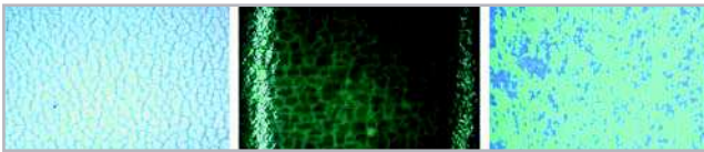
Ejemplos de la degradación de los patrones observados en las tuberías de PP-R en su superficie interna, expuesta a alta concentración de dióxido de cloro o hipoclorito de sodio
