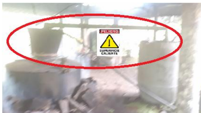
Figura 58. Señalética de peligro superficie caliente.
