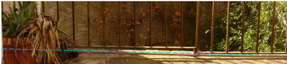
Ilustración 107. Paso de la tubería de agua fría de acero, por debajo de la barandilla de la terraza de P1 para dar servicio a la cocina y el baño de PB
