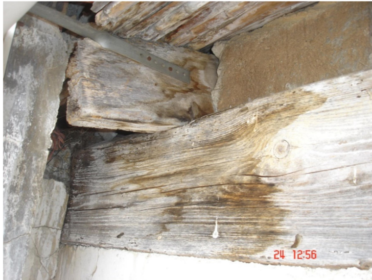
3. Par y viga durmiente del alero en el encuentro con la chimenea de la cocina de PB.
