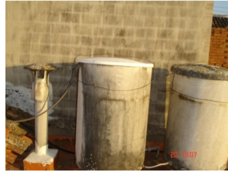
Ilustración 106. Conexión de la canalización de agua fría con los depósitos de fibrocemento.
