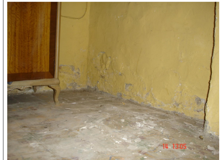
2. Esquina del dormitorio 2 cercana al suelo del patio.
