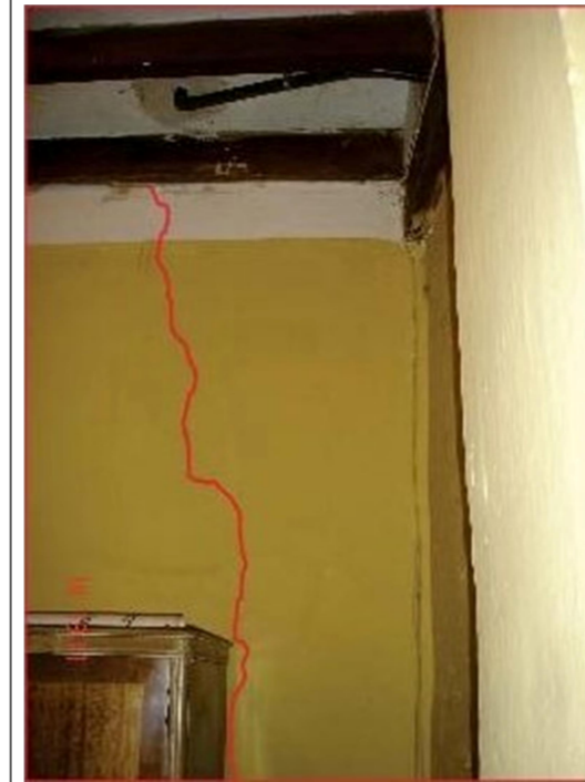
1. Intrados de la Fisura del muro oeste del dormitorio 2 por asiento diferencial de la parte que se une al muro medianero.
