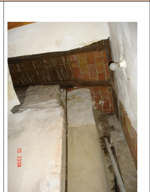
3. Falso techo del descansillo de escalera donde hubo una importante reparación del tejado.
