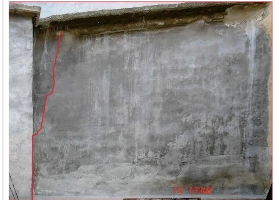
2. Trados de la Fisura del muro este del patio por asiento diferencial de la parte que se une al muro medianero (imagen rectificada).
