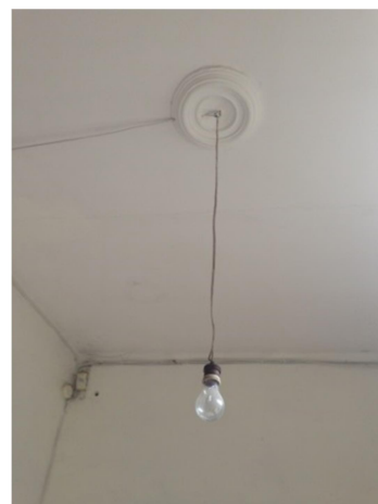
Ilustración 117. Punto de luz de la cocina mediante cableado eléctrico, rosca y bombilla
