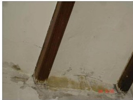
② Humedad en el Techo del Dormitorio 1
