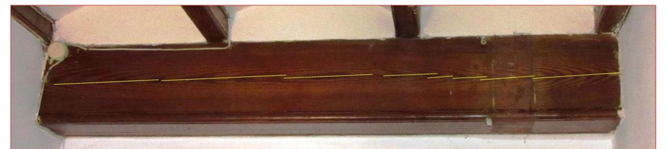
2. Fendas de la viga del forjado principal en la zona del dormitorio 1.
