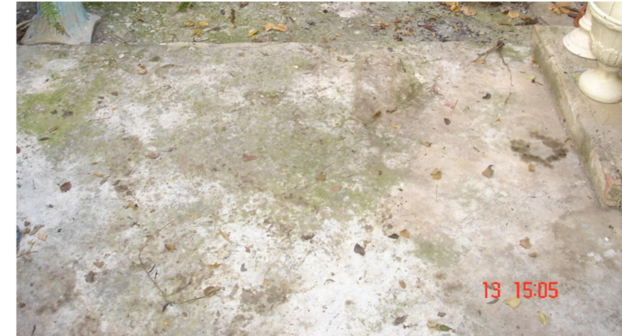
4. Vegetación y musgo en el suelo del patio.
