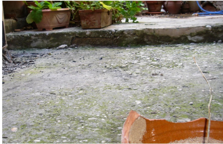
3. Vegetación y musgo en el suelo del patio.
