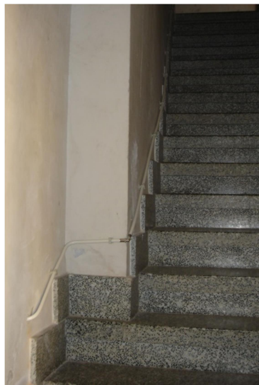
Ilustración 103. Entrada de la instalación de fontanería en la casa
