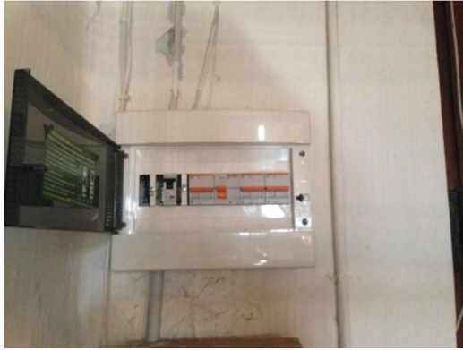
Ilustración 112. Caja General de Protección
