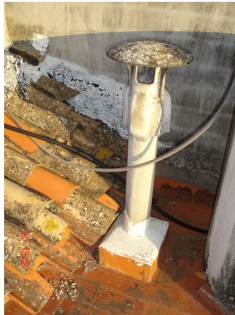
Ilustración 70. Cumbre del tubo de extracción de la chimenea de la cocina de P1
