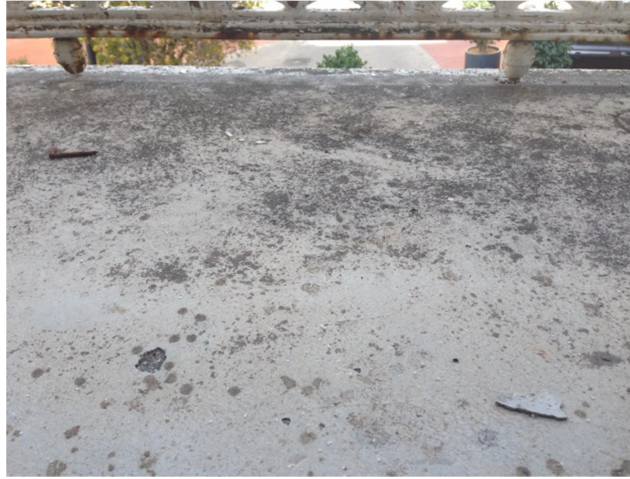
Ilustración 79. Suelo de los balcones de la fachada principal exterior
