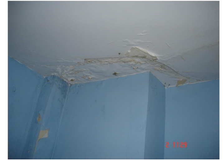
2. Esquina del falso techo del dormitorio 3 cercana al encuentro entre el faldón del tejado con la chimenea de la cocina de PB y el muro medianero.
