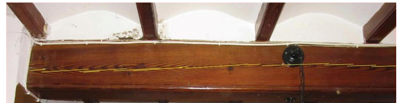
1. Fendas de la viga del forjado principal en la zona de la entrada.
