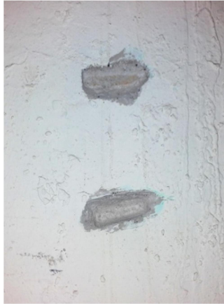
Ilustración 49. Cata en el intradós dintel que cubre el ventanal de la fachada principal
