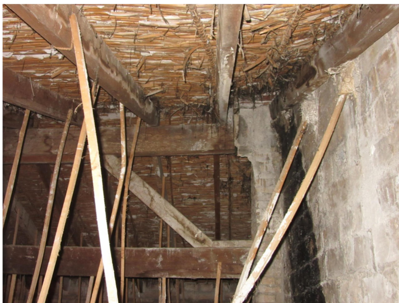
6. Encuentro de la cercha con el muro medianero sur y el estado de los pares cercanos al muro.
