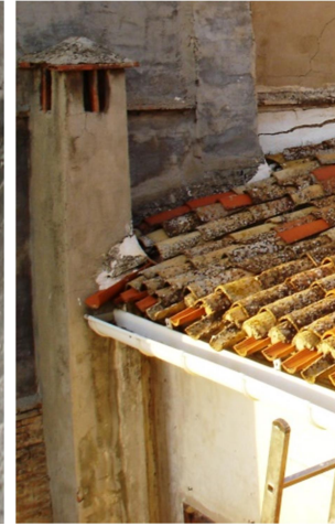
Ilustración 68. Cumbre del tubo de extracción de la chimenea de la cocina de PB mediante sombrerete
