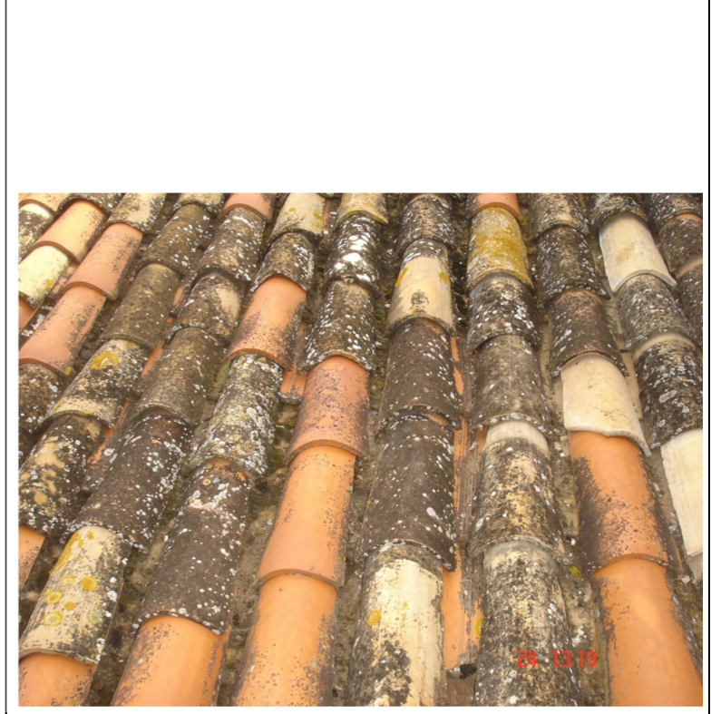
2. Musgo y hongos en el faldón.
