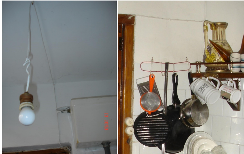
3. Lámpara y cableado del baño.
