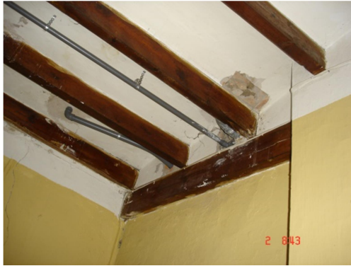
Ilustración 30. Viga entre muro y pilastra zona Nord-oeste del dormitorio principal de PB
