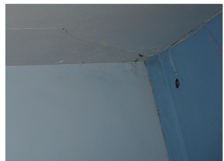
1. Esquina del falso techo del dormitorio 4 cercana a la bajante del canalón oculto.
