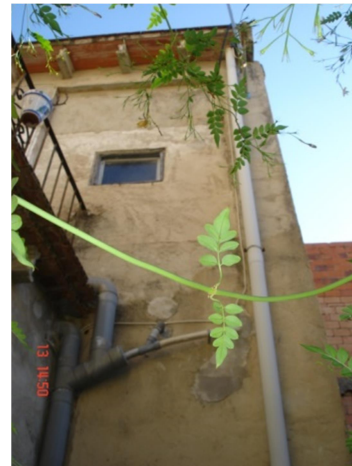
Ilustración 109. Bajante de aguas pluviales de la azotea y tejado, y aguas fecales de P1
