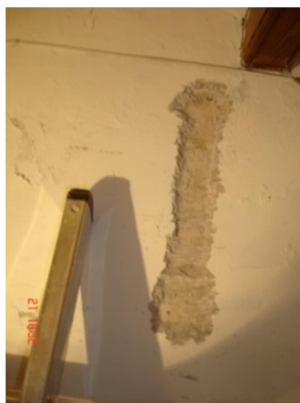
Ilustración 47. Cata en el intradós del dintel de hormigón armado del portón
