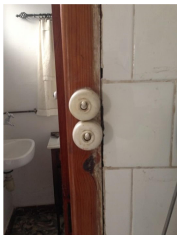
Ilustración 116. Interruptores antiguos del aseo de PB
