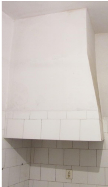
Ilustración 69. La campana de la chimenea de la cocina de P1
