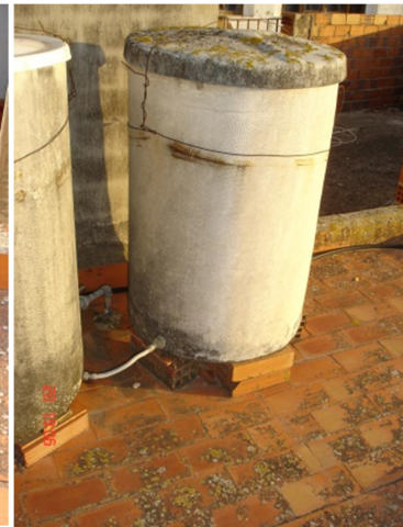
Ilustración 42. Depósitos de fibrocemento en la azotea
