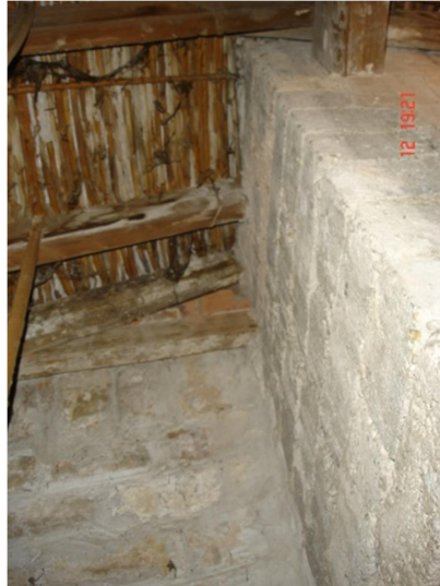
Ilustración 25. Muro de bloque de hormigón con apoyo de la cercha de cubierta.
