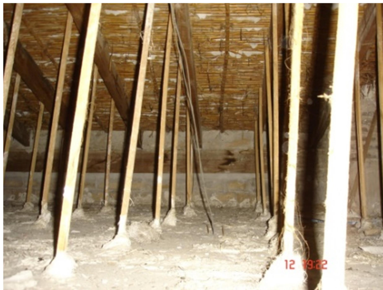
Ilustración 29. Apoyo de cargas de cubierta en estructura vertical de la fachada interior-patio y muro de medianera
