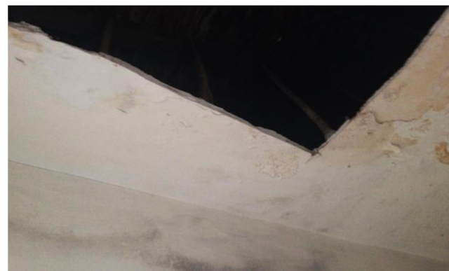
Ilustración 86. Hueco en Falso techo de P1, en la escalera
