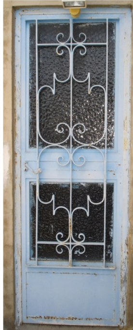
Ilustración 99. Vista frontal exterior puerta simple de acceso a la terraza de P1
