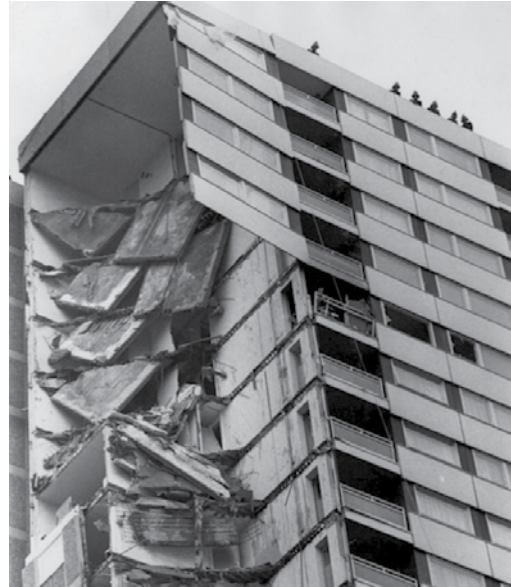
Gráfico 106: Derrumbamiento de la torre prefabricada Ronan Point en Londres en 1968 Fuente: http://mixstuff.ru/archives/29798/ronan-point
