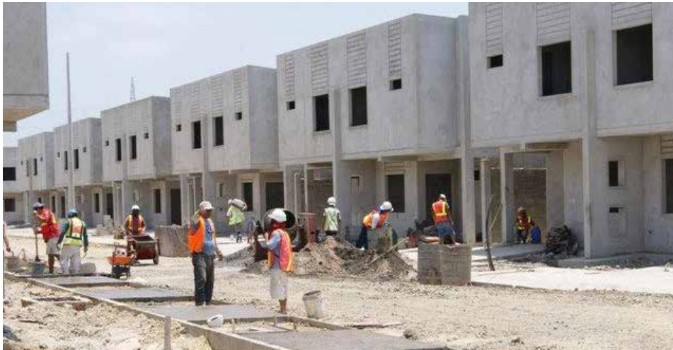
Gráfico 282: Proyecto habitacional del Banco Ecuatoriano de la Vivienda (BEV) Fuente: http://www.lahora.com.ec/index.php/noticias/show/1101505925#.VkUuu3YvfiU pontificia-universidad-catolica-de-chile-imagen
