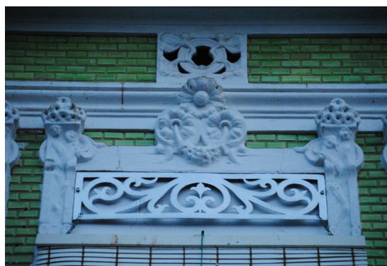
Calle de Escalante 238 Guardamalleta de perfil rectangular de lámina de hierro perforada con fantasía vegetal
