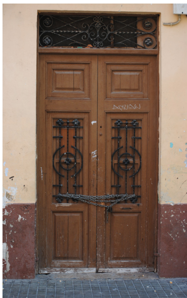
Calle los Ángeles 68 Portón de dos hojas de madera con rejas centrales y superiores con fantasía floral
