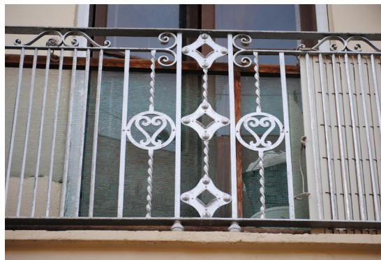
Calle del Progreso 99 Barandilla de hierro forjado con motivo central con fantasías simples
