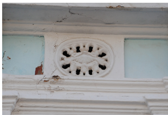
Calle de Escalante 56 Respiradero de perfil oval de piedra artificial con elementos curvilíneos
