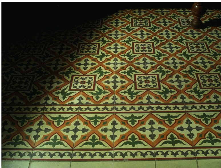
Calle del Progreso 306 Baldosa hidráulica de pavimentación en fantasía compleja con arabescos
