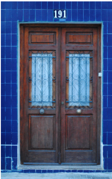
Calle Barraca 191 Portón de dos hojas de madera con rejas con fantasías simples
