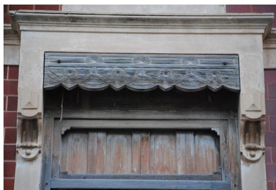
Calle Barraca 135 Guardamalleta de perfil rectangular de madera labrada con fantasías simples
