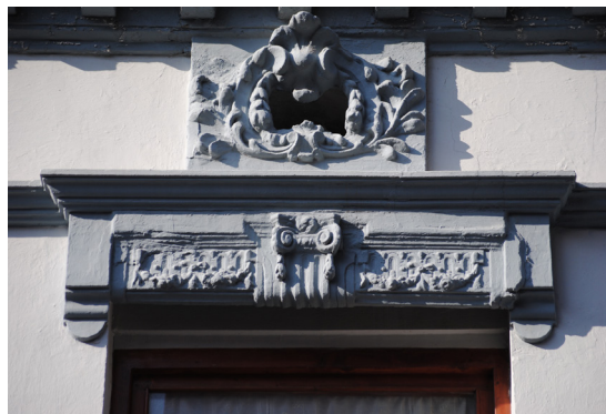
Calle de los Angeles 5 Guardapolvo de perfil rectangular de piedra artificial con elementos vegetales, florales y capitel jónico central
