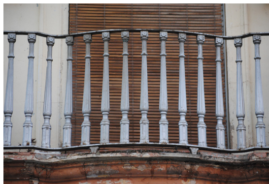
Calle Barraca 33 Barandilla de hierro fundido con elementos inspirados en columnas
