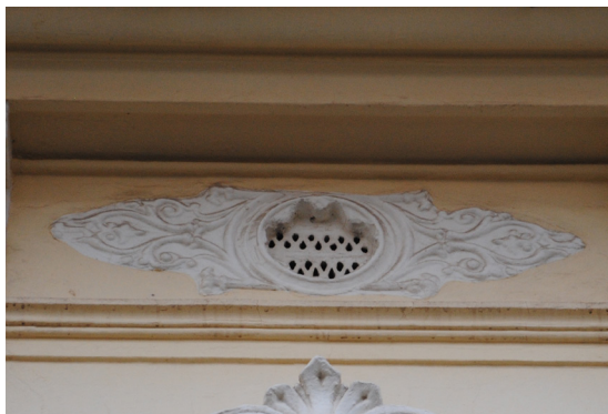
Calle Jose Benllure Respiradero de perfil oval de piedra artificial con tracerías y elementos vegetales
