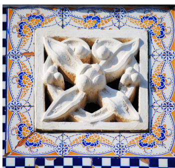
Calle de Escalante 323 Azulejo de mayólica plano decorado por el sistema de trepas con fantasía policroma con elementos vegetales y guirnaldas
