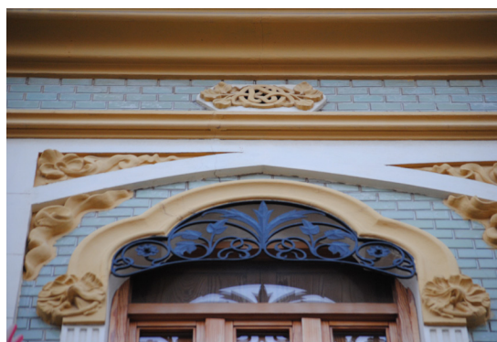
Calle Jose Benllure 75 Guardamalleta de perfil curvado de hierro forjado con elementos florales y vegetales
