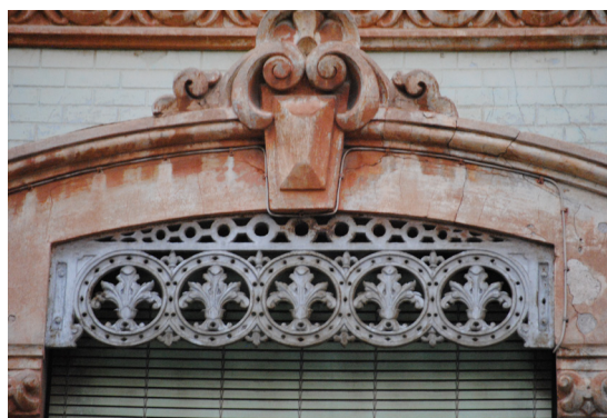
Calle de la Reina 150 Guardamalleta de perfil curvado de hierro fundido con elementos vegetales y círculos
