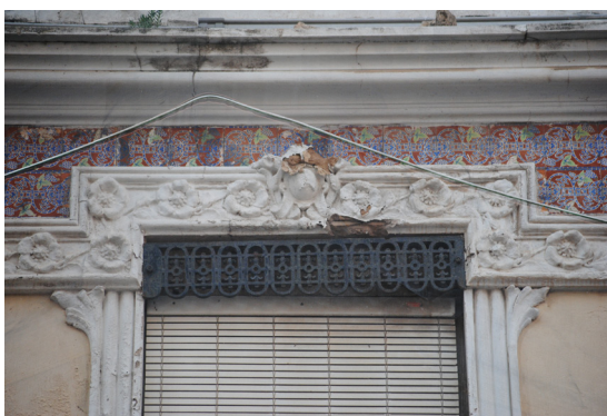
Calle Jose Benllure 285 Guardamalleta de perfil rectangular de hierro fundido con fantasías simples repetidas
