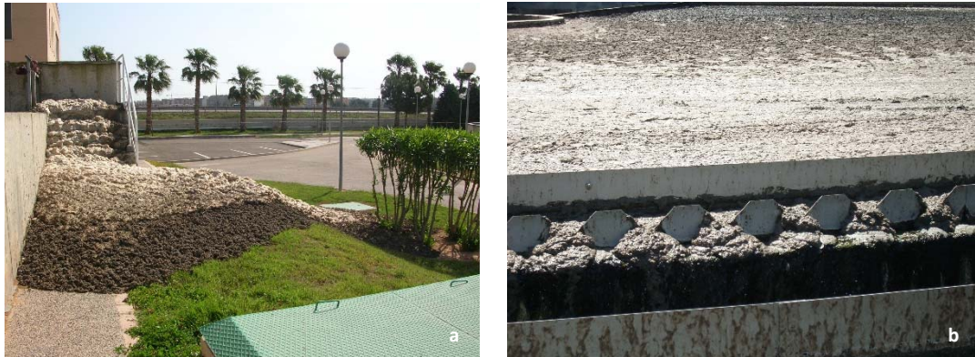
Figura 1.12. Problemas de foaming en planta. Escape de espumas biológicas del reactor biológico (a) y del clarificador secundario (b). Autor: Andrés Zornoza.
