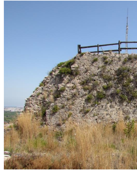
Imatge 46. Despreniment al mur sud.
