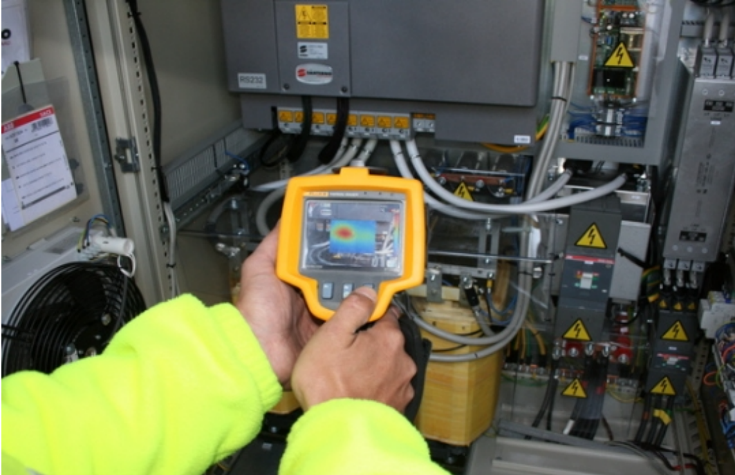
Figura 40: Monitoreo de temperatura en el cuarto de distribución energética.
