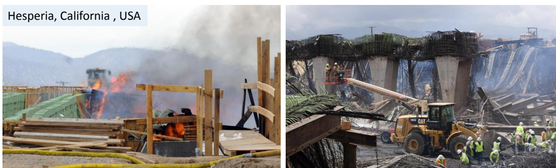
Figura 7. Incendio en Hesperia (2014). Colapso de la estructura cuando se encontraba en construcción. Fuente: latimes.com
