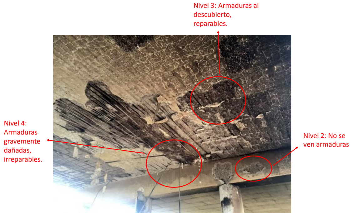
Figura 5. Ejemplo de niveles de daño en puente de hormigón. Rampa I-270 con I-70, Ohio, USA. Fuente: wohio,
