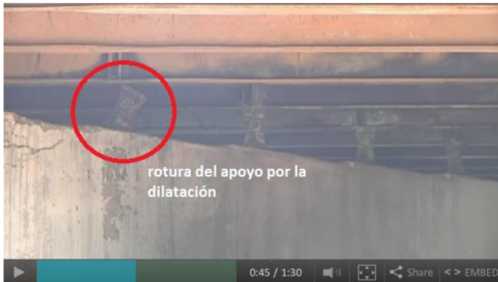
Figura 39. Rotura del apoyo fijo debido a la expansión de las vigas y los fuertes esfuerzos axiales que aparecen. Fuente: NBCDFW.com
