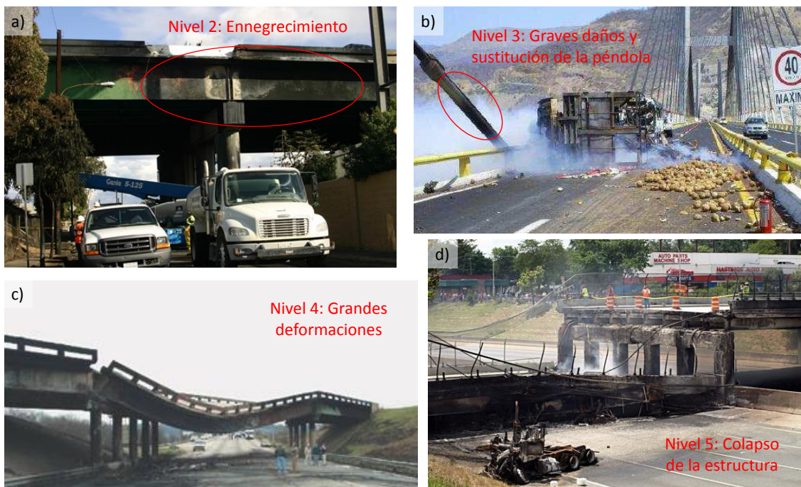
Figura 4. Algunos ejemplos de daños en puentes para puentes de acero. (a) Nivel de daño 2: Ennegrecimiento de la estructura sin sufrir deformaciones en puente en Commerce, CA, Estados Unidos. Fuente: EGP Photo. (b) Nivel de daño 3: la péndola tuvo que ser remplazada debido a los graves daños en Puente Mezcala, Mexico. (c) Nivel de daño 4: I/20/I-59/I-65 intercambiador en Birmingham, Alabama, Estados Unidos. Imagen cortesía del departamento de Alabama de Transportes. (d) Nivel de daño 5: Colapso de uno de los vanos del Puente sobre la I-75 cerca de Hazel Park en Detroit, MI, Estados Unidos. Fuente: jalopnik.com
