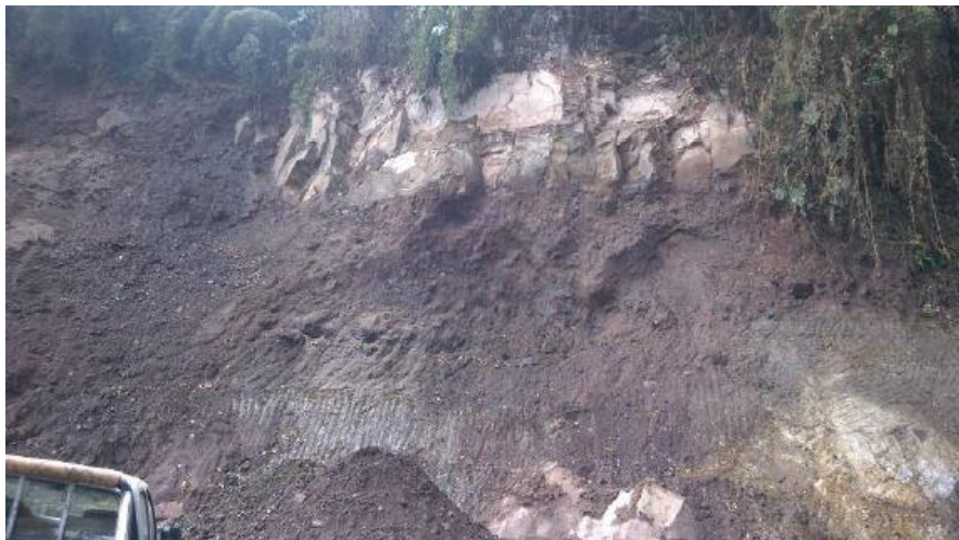
Fotografía 7. Talud escarpado, posible caída de bloques.
