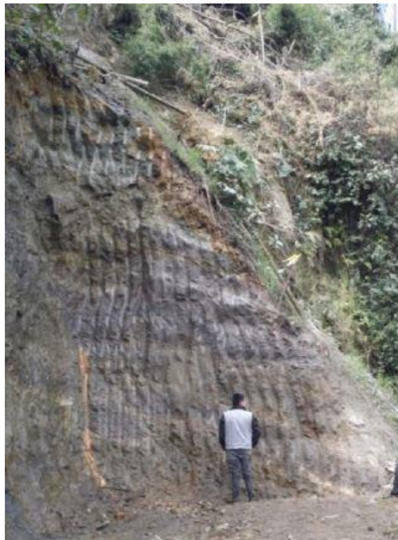
Fotografía 9. Deslizamiento rotacional en el emboquille de salida.
