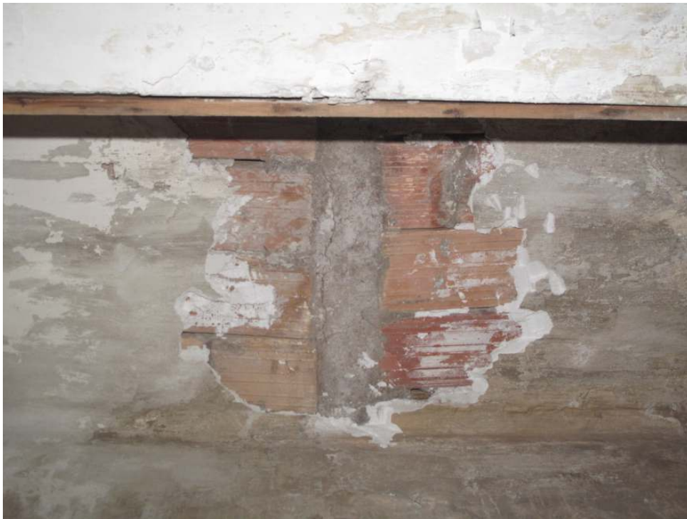
Imagen 3 Detalle ejecución original vigueta
