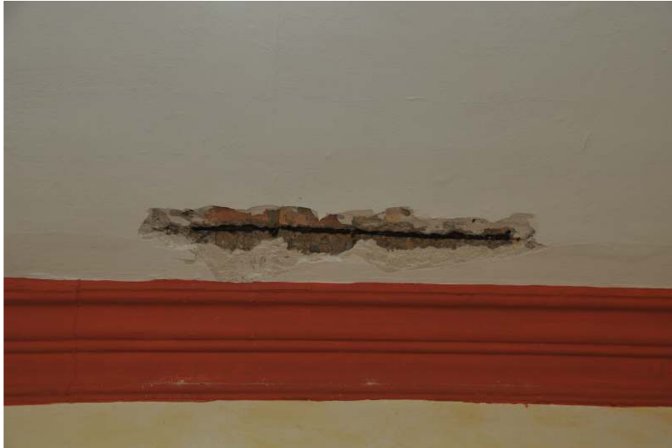
Imagen 2 Estado actual vigueta a reforzar
