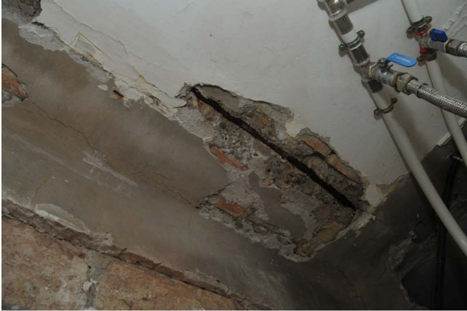
Imagen 4 Estado actual vigueta a reforzar
