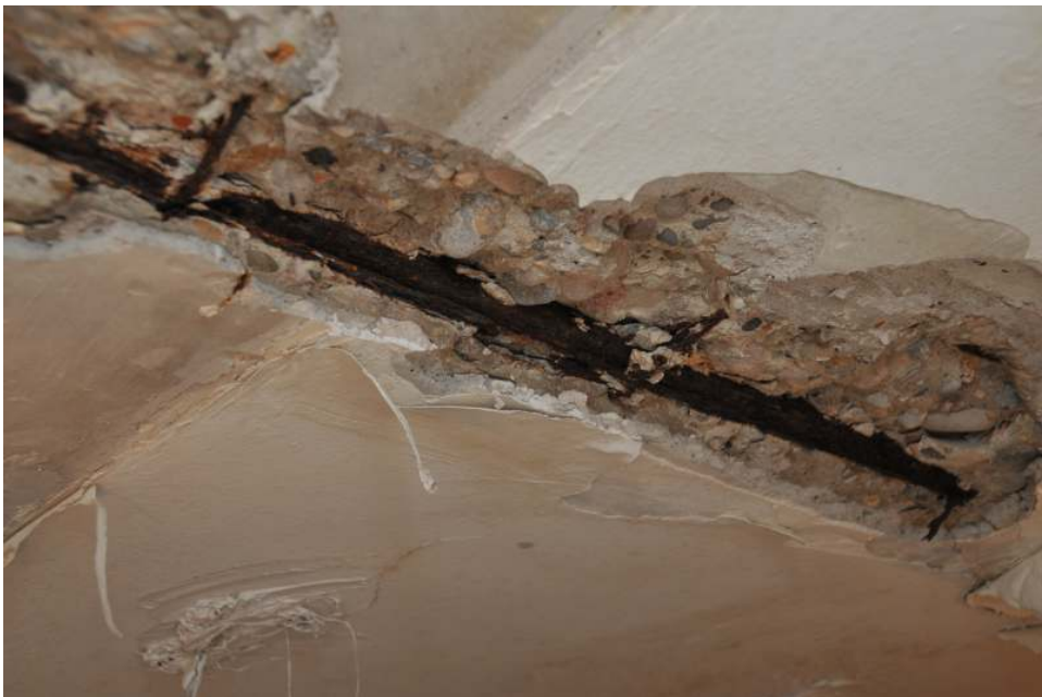
Imagen 5 Detalle estado actual vigueta a reforzar
