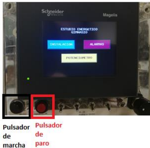
Figura 18: Pulsadores de marcha y paro de la instalación
