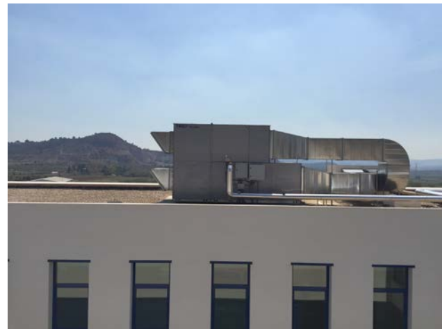
Unidad de Tratamiento de Aire - UTA en la cubierta
