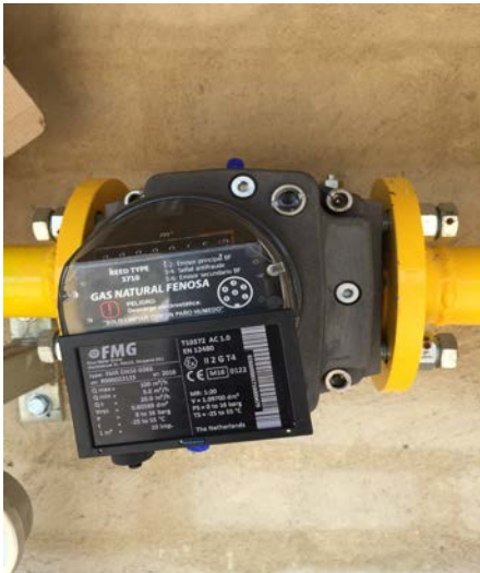
Contador G 65 – Sala de Calderas Tipo “de pistones” Tienen mucho menor volumen
