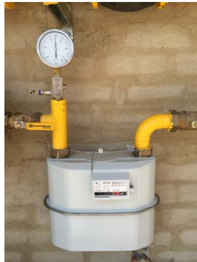
Contador G 16 – Cocina Tipo “de membrana”
