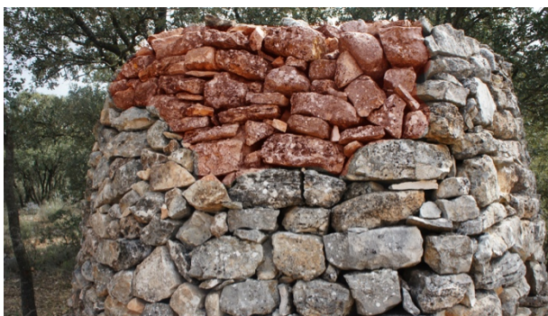
Figura 7. Utilización de mampuestos locales, de tamaño más reducido que los originales, para reparar lagunas (autores)
