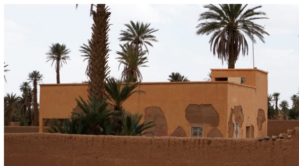
Figura 6. Vivienda diseminada correspondiente al segundo periodo de transformación, construida con técnicas tradicionales, y enfoscada por el exterior con mortero de cemento, en la que se observan grandes patologías por desconchones.
