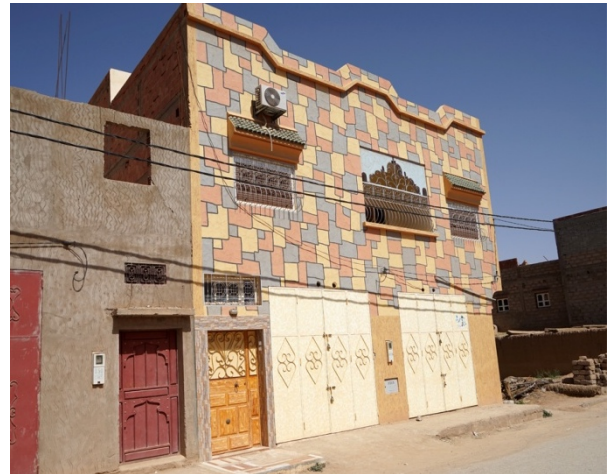
Figura 10. Vivienda de nueva construcción en donde se observa el rebaje en el muro de la azotea.
