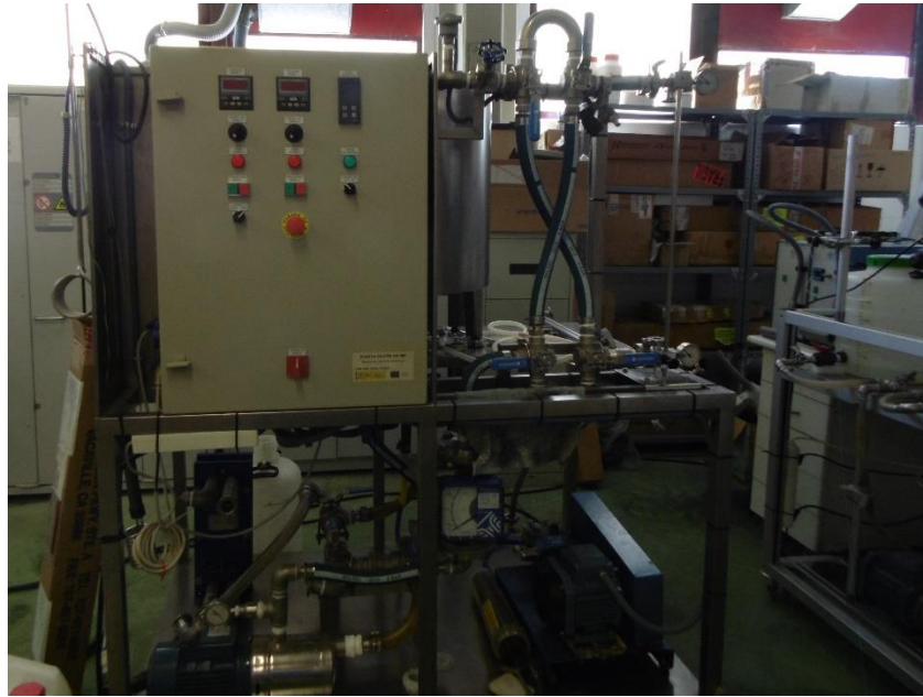
Figura 11: Planta piloto de ultrafiltración.
