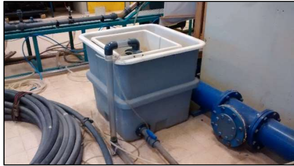
Fotografia V Depósito atmosférico de regulación
