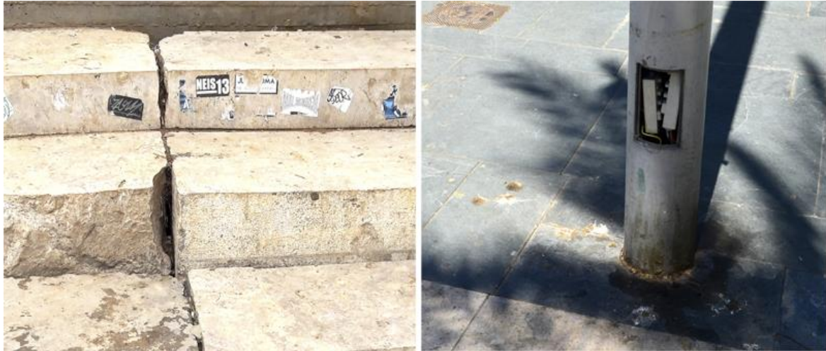
(Fig. 30) Roturas e incisiones (izquierda), y mal estado de una farola con los cables a la vista (derecha).
