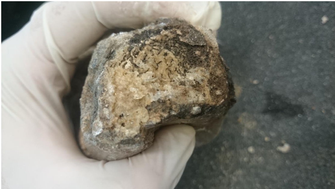
Foto 4. Restos de adhesivo de restauraciones anteriores
