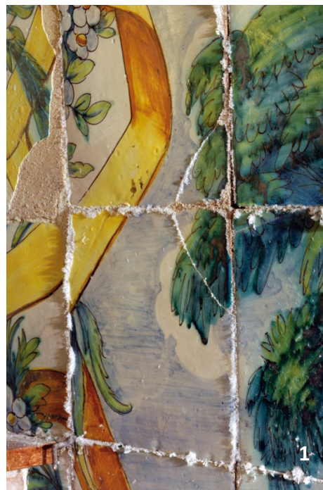
1.- Detalle de los daños por sales eflorescentes 2.- Detalle inicial de reposición antigua
