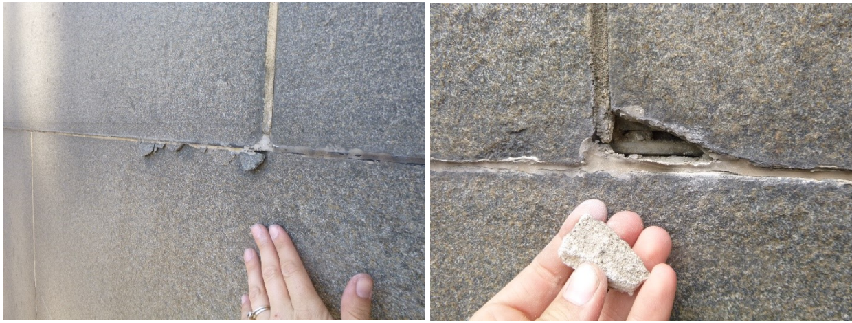
Figura 3.4-12 Desprendimientos menores de material. Ejemplo genérico de algunas de las lesiones documentadas en TPAS.
