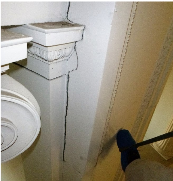
Figura 3.2-6 La fotografía muestra la lesión investigada, cuadros de grietas en las pilastras de la cúpula central, en la pilastra #6.
