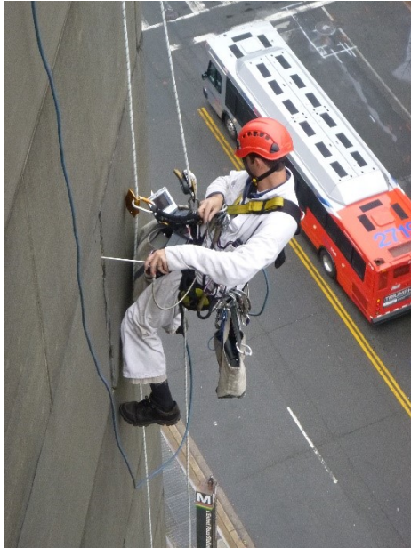
Figura 3.4-3 Investigación con boroscopio rígido. En lugar de utilizar el visor, el técnico utiliza el monitor del sistema de grabación de vídeo para ver la cara trasera del aplacado.
