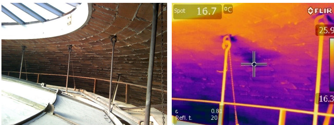
Figura 3.3-9 Los tres conectores de acero en el extremo derecho en la imagen de la izquierda mostraban filtraciones activas en su encuentro con la cúpula superior tal y como puede observarse en la mancha oscura del termograma de la derecha.
