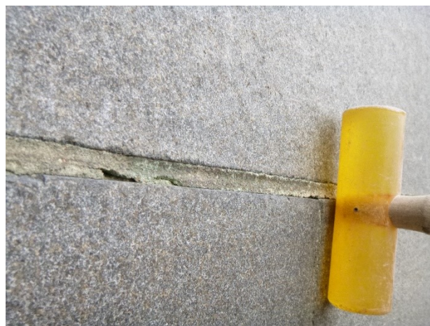
Figura 3.4-4 Martillo acrílico de 13 onzas utilizado para el sondeo por percusión de cada una de las piezas de granito.
