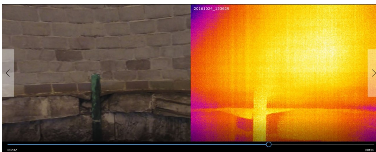
Figura 3.5-16 A la izquierda, fotografía tomada con el UAS del encuentro entre la cúpula de Guastavino y el tambor de piedra. En el termograma de la derecha se observa el reflejo del ladrillo vidriado de la cúpula (no debe confundirse con una zona más caliente) y que la primera hilada de ladrillos de la base de la cúpula está más fría. Puede ser un indicio de humedad, sin embargo, esta imagen no permite confirmarlo.
