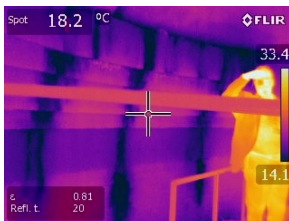
Figura 3.3-6 Termograma del encuentro en la base de la cúpula entre el ladrillo y la piedra sobre la que se asienta. Las manchas más oscuras corresponden a áreas con menor temperatura, en este caso, áreas con presencia de agua.
