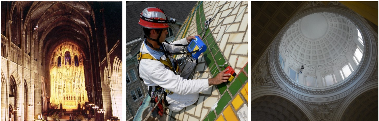
Figura 2.6-20 La fotografía de la izquierda corresponde a una inspección de las bóvedas de Guastavino por el intradós en la iglesia de St. Thomas en Manhattan; se realizó test de percusión con ladrillo e instalación de monitores de grietas. La foto central se tomó durante una inspección consistente en mapear los elementos metálicos desde el trasdós de la bóveda principal, de Guastavino, en la iglesia de St. Francis the Sales en Philadelphia. En la tercera imagen se observa a un arquitecto suspendido de un sistema industrial de cuerdas en el interior de Grants Tomb en Manhattan; durante la inspección se utilizaron boroscopios, termografía, instalación de monitores de grietas y TPAS (V.A. LLC)
