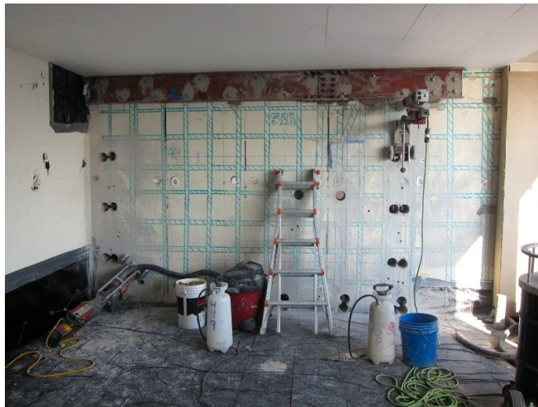
Figura 2.4-54 Fase de demolición parcial, una vez analizada la función del muro y su necesidad. Obsérvese en la parte superior el refuerzo a modo de viga que se añadió para soportar los forjados superiores (G. Pardo).
