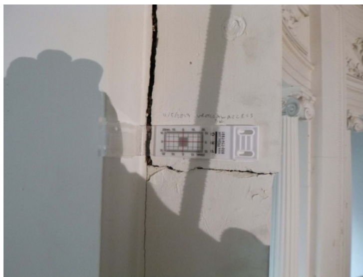
Figura 3.2-9 Sistema de monitoreo de grietas instalado como parte de la evaluación.
