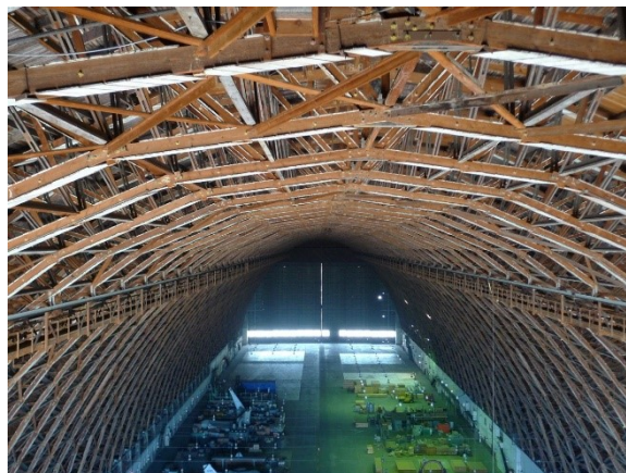
Figura 1.4-18 Hangar en Moffett (CA), construida en 1933, es una de las estructuras históricas más significativas de Silicon Valley y una de las mayores estructuras de madera del mundo. Diseñada por K. Arnstein y W. Watson en madera debido a la escasez de acero en el periodo entre guerras (K. Diebolt).
