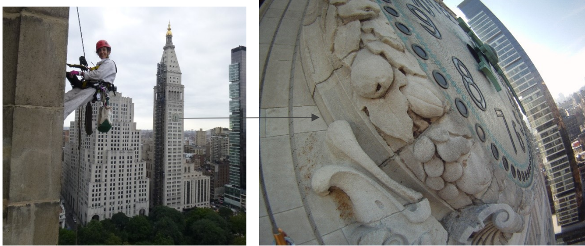
Figura 2.6-14 La fotografía de la izquierda fue tomada durante la inspección, por medio de sistemas industriales de cuerdas, de 512 5 th Avenue, en Manhattan. Arquitectos e ingenieros descenden, o son descendidos, a las zonas que necesitan evaluar. El edificio coronado en pirámide es Metropolitan Life Tower de Napoleon LeBrun & Sons, el edificio más alto del mundo de 1909 a 1913. La fotografía de la derecha se tomó durante la inspección, con acceso mediante sistemas industriales de cuerdas, de los ornamentos de piedra tallada del reloj. Acceder a esas áreas de la fachada con andamios convencionales, costaría millones de dólares, lo que imposibilitaría las investigaciones de END en muchos de los proyectos (K. Olson).
