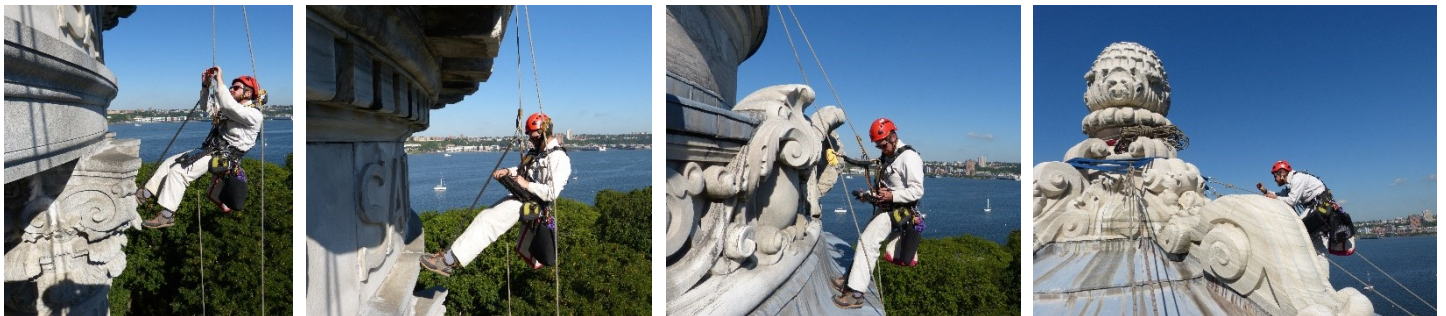
Figura 3.5-4 Secuencia del recorrido ascendente del ingeniero en su tarea de inspección visual próxima y documentación de lesiones y condiciones en el archivo TPAS-CAD mediante una cámara digital y una Tablet que hipervincula las fotografías.
