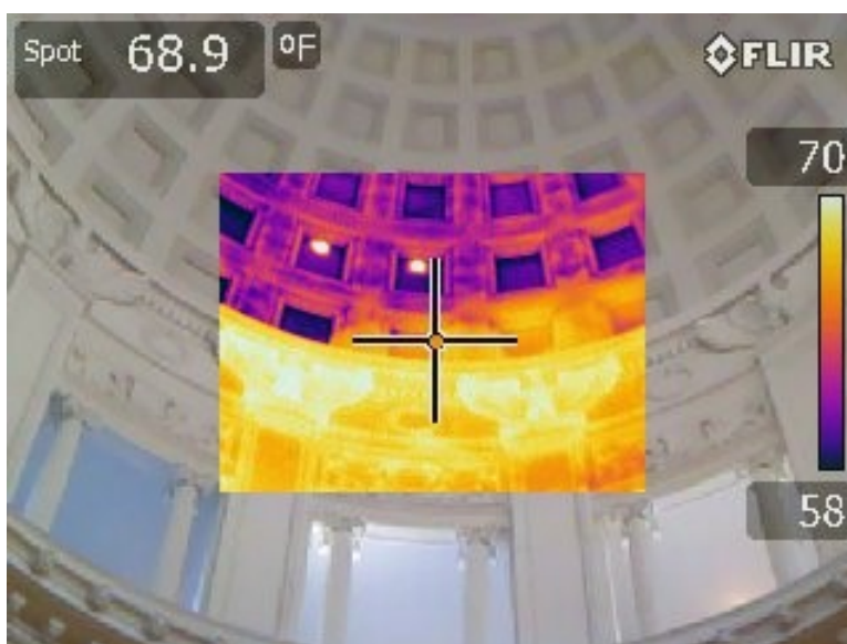
Figura 3.2-2 La imagen muestra un termograma dentro de una fotografía digital de la cúpula. El termograma es el resultado de aplicar termografía activa a través de una pistola de calor desde el trasdós, con el fin de relacionar la posición de los casetones de yeso vistos en el intradós, para averiguar dónde anclar las cuerdas para acceder al intradós y para proceder a la inspección desde el trasdós y el intradós.
