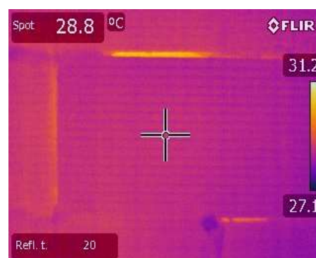
Figura 4.3-28. Termograma del ladrillo 29 en el que claramente se aprecia la falta de junta.
