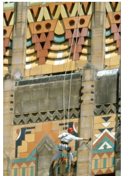
Figura 2.6-18 Ayuntamiento de Búfalo. El objetivo de la investigación con END era localizar los anclajes metálicos para determinar su estado, en función del resto de patologías encontradas en la decoración Art Déco de terracota y el aplacado de piedra caliza. La duración del proyecto fue de cuatro días para cuatro arquitectos. Su coste aproximado fue de $30.000. Este mismo proyecto utilizando como medio de acceso un andamio tradicional, hubiera costado millones de dólares y durado meses. La flecha amarilla señala al técnico realizando la evaluación (V.A. LLC).
