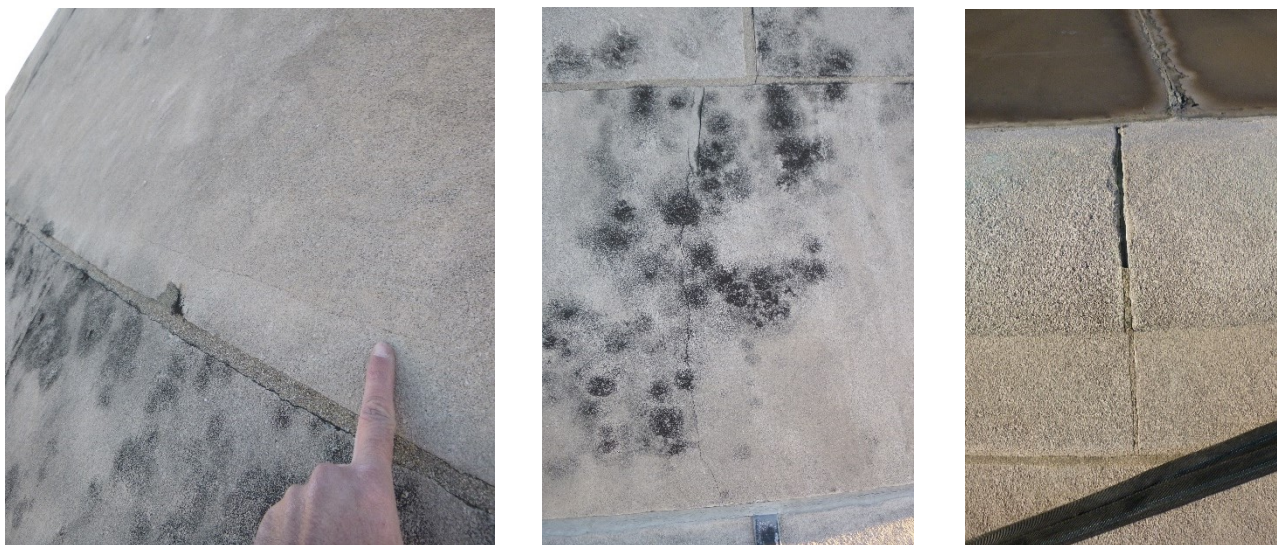
Figura 3.3-2 Lesiones comunes documentadas durante la inspección visual del exterior de la cúpula; grietas y fisuras horizontales al mismo nivel alrededor de la cúpula (a la izquierda), sistemas de grietas verticales previamente reparadas que han vuelto a abrir (centro) y mortero faltante o muy deteriorado en las juntas entre unidades de piedra (derecha).
