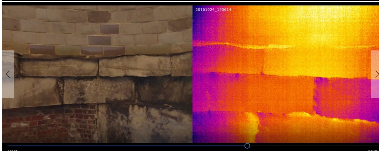
Figura 3.5-15 En ambas imágenes, la fotografía de la izquierda fue tomada con el UAS utilizando la cámara instalada y los termogramas fueron registrados con el mismo UAS, mediante una cámara térmica. Fotografía y termograma pertenecen a la misma zona del monumento. Lo que parecen zonas de humedad en las fotografías se confirma en los termogramas con tonos morados, correspondientes a zonas más frías.
