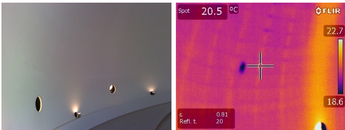
Figura 3.3-14 Fotografía/termograma que muestra una filtración activa. Obsérvese que no es posible percibir la filtración a simple vista (zona oscura en el termograma).
