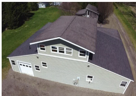
Figura 2.6-10 Imagen de un tejado en Ithaca (NY) tomada con una GoPro Hero3+ montada en un DJI Phantom cuadricóptero, para evaluar los daños provocados por un tornado (J. Haun).
