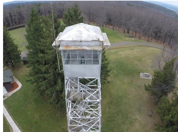
Figura 2.3-26 Imagen de torre de vigilancia tomada desde un UAV para generar un modelo 3D con Pix4D.
