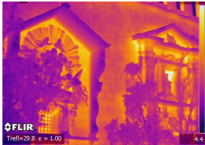
04.17. Imagen de la cámara termográfica en la fachada de la plaza del Mercado 117 .
