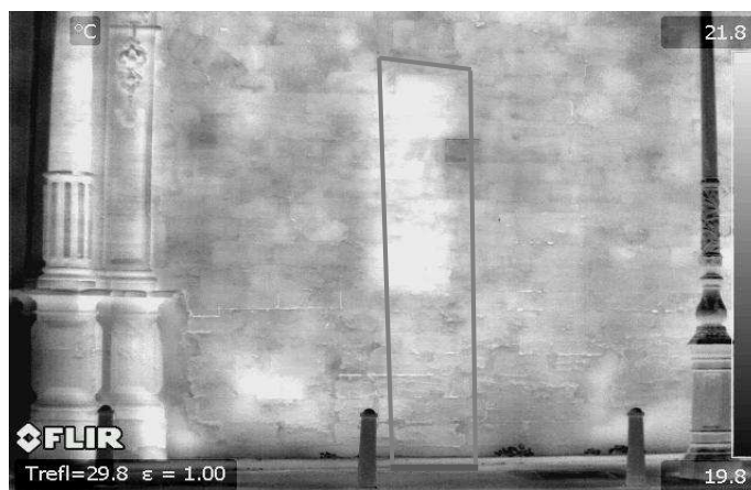
04.20. Imágen Termografica de la fachada del Cementerio de San Juan 119 .
