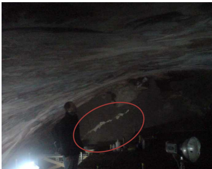
06.110. Grieta de la fachada de la plaza del cementerio de San Juan, cercana al encuentro con la bóveda barroca. Modelo 5 140 .
