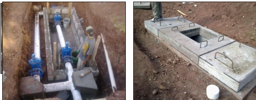
Ilustración 4: Construcción de una UOC en un sector de la RDAP de la ciudad de Tegucigalpa, Honduras (Proyecto implementado por consultora española Wasser para el Sistema Nacional de Acueducto y Alcantarillados –SANAA– de Honduras)
