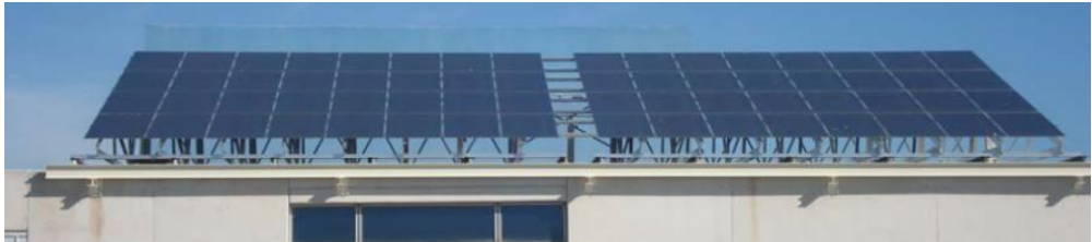
Figura 2-9 Planta fotovoltaica ETSID
