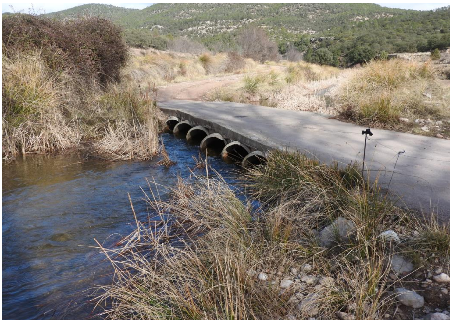
Figura 5. Imagen ejemplo de tipo de obstáculo de Paso entubado, no se encuentra en el Inventario de Azudes de la CHJ.
