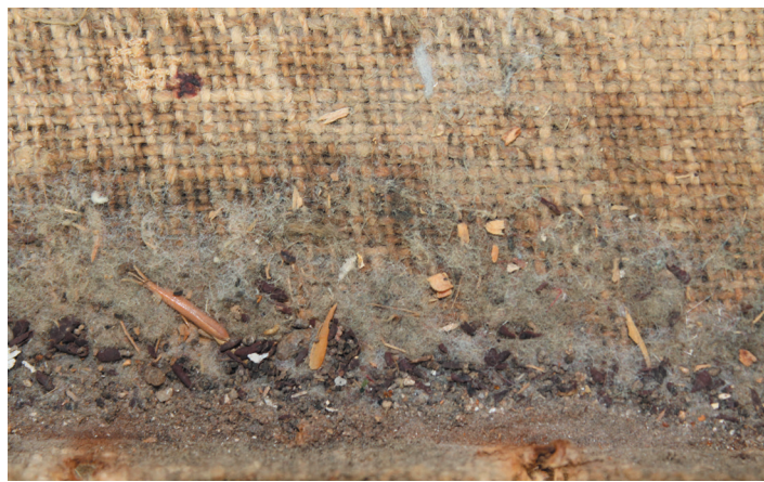
Fig. 31: Fotografía de la suciedad superficial encontrada en la zona inferior del soporte.
