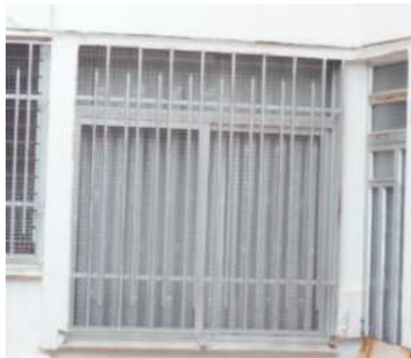
Figura 24: Carpintería de aluminio en la vivienda. 2017. Fuente: propia
