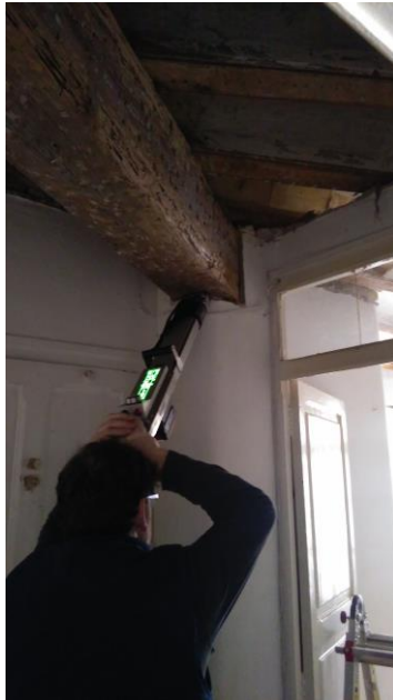
Figura AII.1. Realizando una resistografía en una viga de carga en la inspección de Calle Gandía. 2017. Fuente propia.
