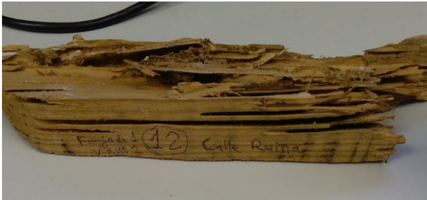
Figura 1.4. Madera degradada por termitas. 2017. Fuente propia.
