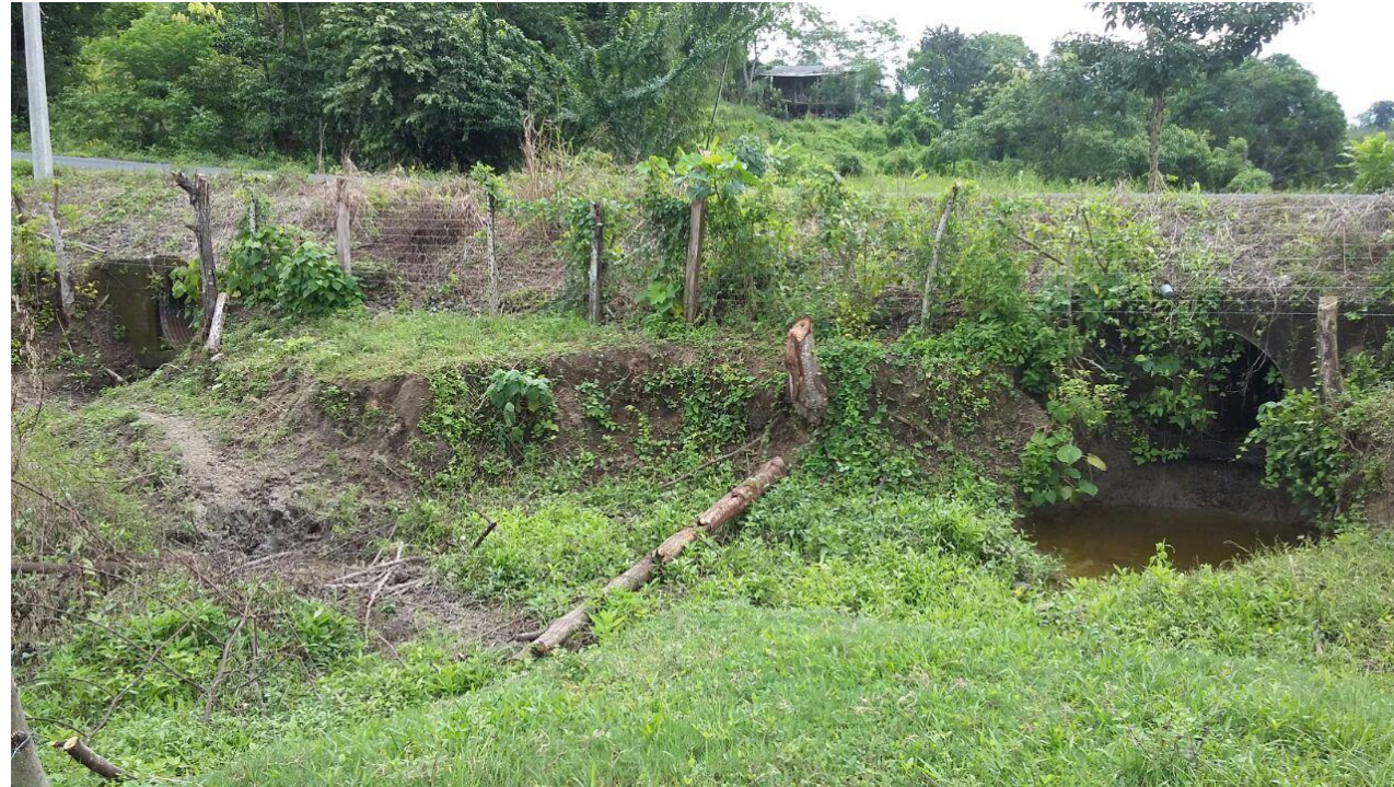
Imagen 5. Conductos (2) de drenaje para conducir las aguas por debajo del camino. Límites finca parte Este. Diámetro 1.2 m, separación entre conductos 11 m. [Fuente propia]
