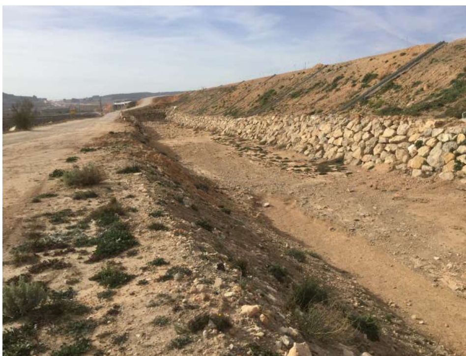
Fig. 6 - Canal de drenaje que conduce el agua hasta el barranco dels Molins. FUENTE: Juan B. Marco Segura
