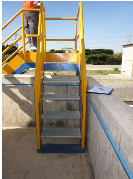
Ilustración 7. Escalera acceso a cubeta EDAR.
