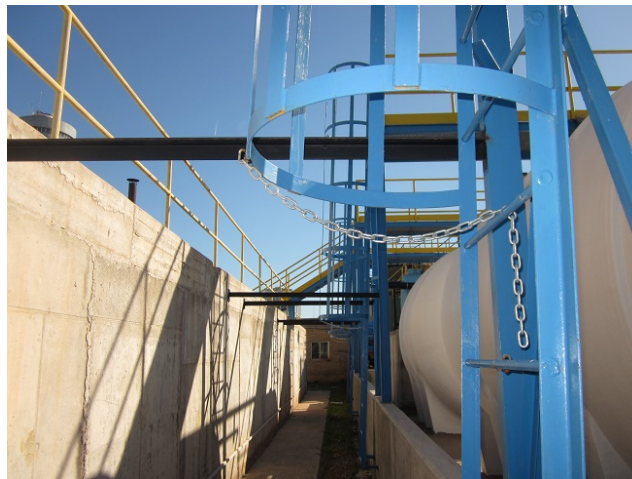
Ilustración 6. Escalas acceso a pasarela.
