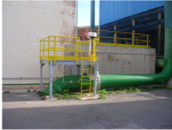
Ilustración 13. Plataforma acceso al grifo de toma muestra
