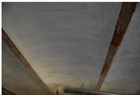
Figura 46. Forjado sótano con oxidación en viguetas. Febrero 2017.
