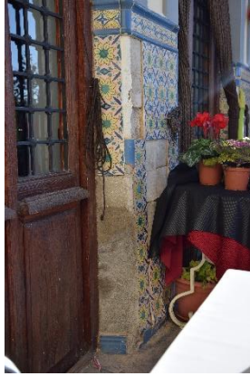
Figura 47. Desprendimiento de azulejos en la terraza. Febrero 2017.
