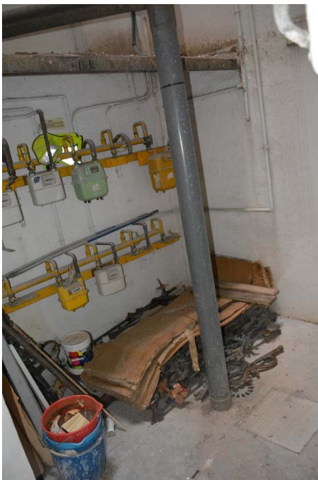
Fig. 2.58. Imagen de contadores de gas en patio de luces. Fuente propia.
