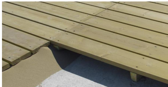
Figura 29. Ejemplo de instalación de listones y rastreles. Fuente: Catálogo MADERA CUNIL S.A.
