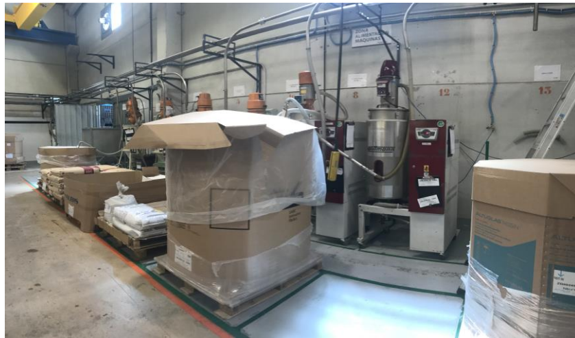
Figura 4.18 Deshumidificadores utilizadas en la planta
