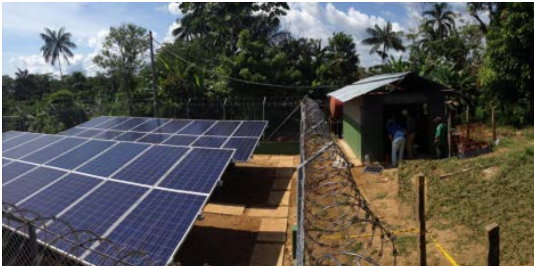
Figura 5. Sistema híbrido diesel-fotovoltaica de Palmeras. ENAM.
