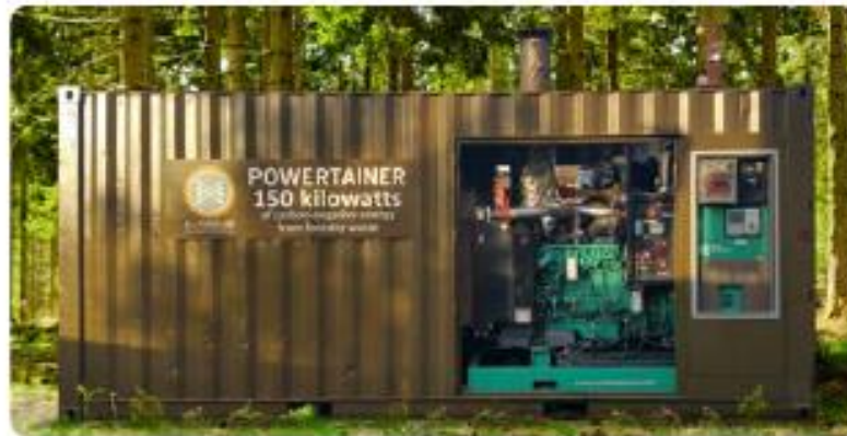
Ilustración 24: Imagen del generador de 150 Kw
