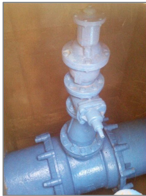
Figura 3.4.2-1. Ventosa 1s. Subida al depósito Ponera 1.
