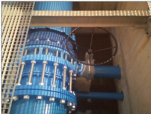
Figura 3.4.1-3. Válvula mariposa salida impulsión 2.
