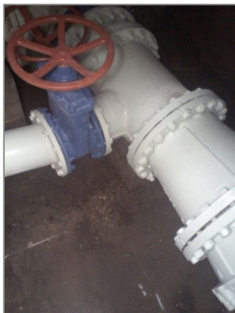
Figura 3.4.1-1. Válvula de compuerta la T de conexión a Sagunto.
