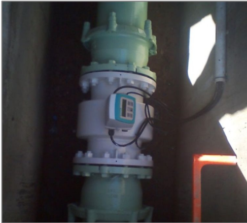
Figura 3.4.5-1. Caudalímetro salida depósito Ponera 1.
