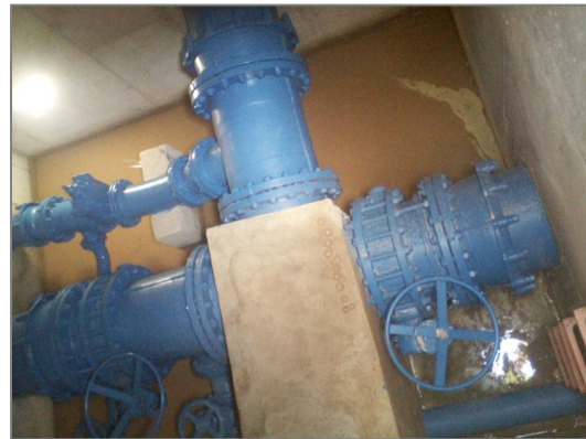
Figura 3.4.1-4. Válvula mariposa justo antes de la T subida depósito Cota 75 y tras salida Cota 55.
