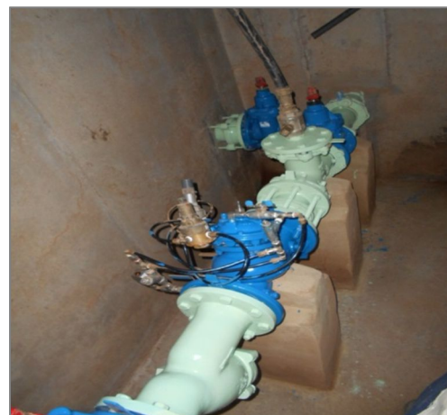
Figura 3.3.7-2. Arqueta con VRP derivación Gilet
