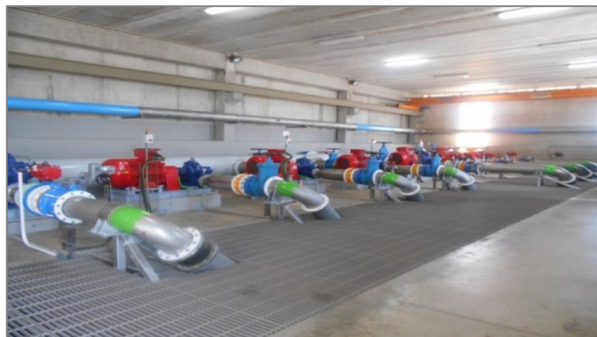
Figura 3.2. Estación de bombeo ETAP.
