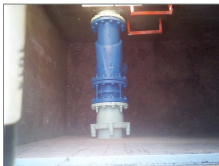
Figura 3.4.4-1. Filtro entrada depósito Canet d'En Belenguer.
