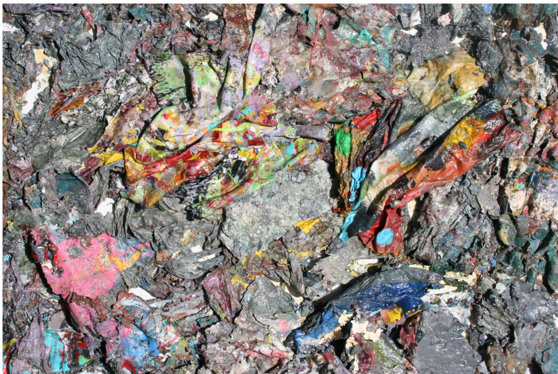
Figura 5 – Detalle de las capas desprendidas del piso.
