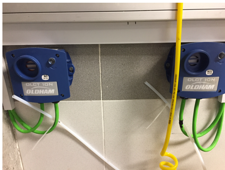
Figura 4.17. Sensores de NO y NO 2 en planta.
