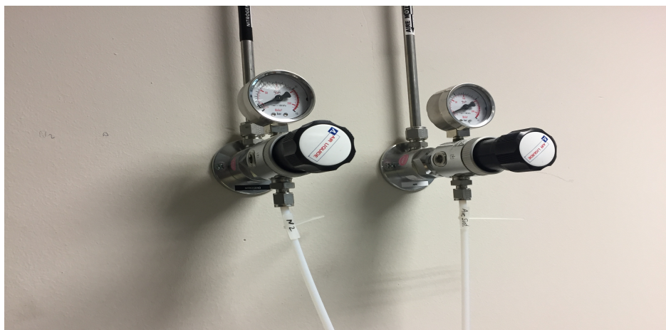
Figura 4.13. Suministro de nitrógeno y aire al generador desde otra instalación dentro del CMT.
