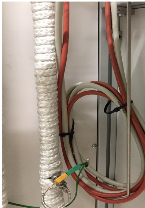
Figura 4.10. Conducto del mezclador.
