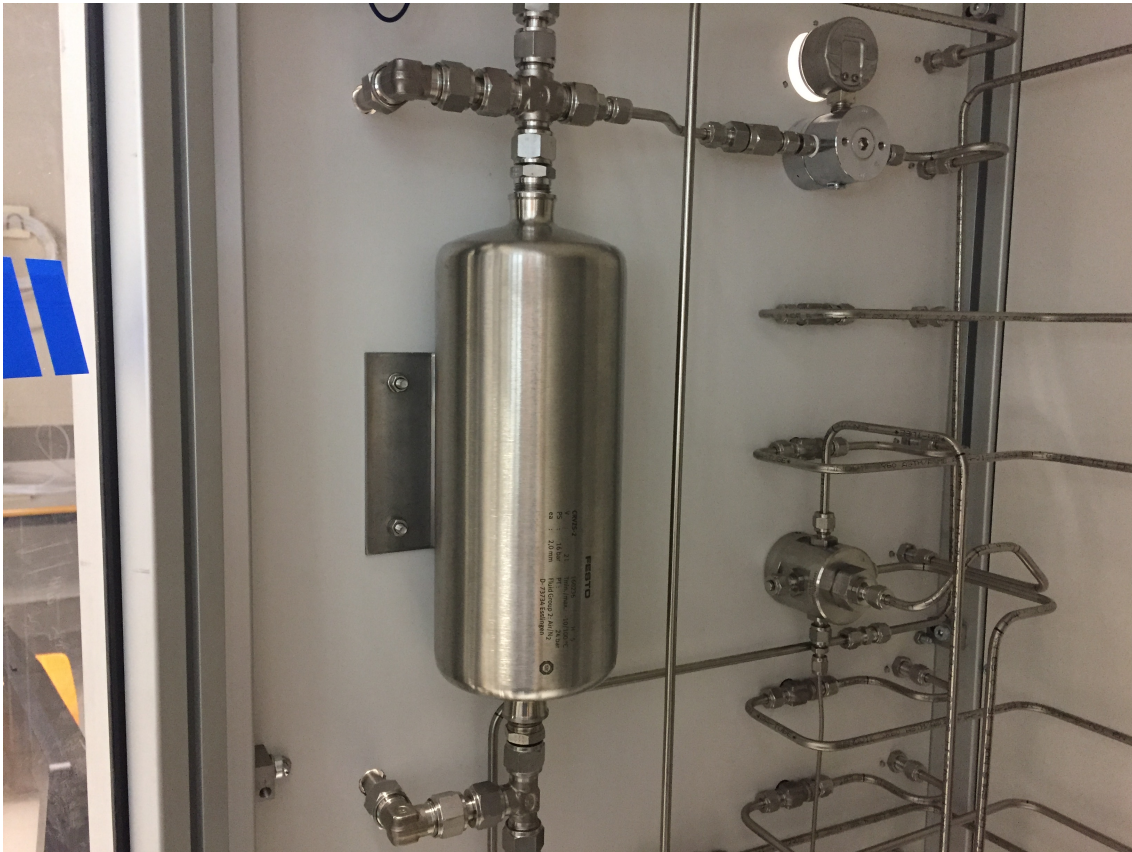
Figura 4.5. Deposito de agua alojado dentro del banco.
