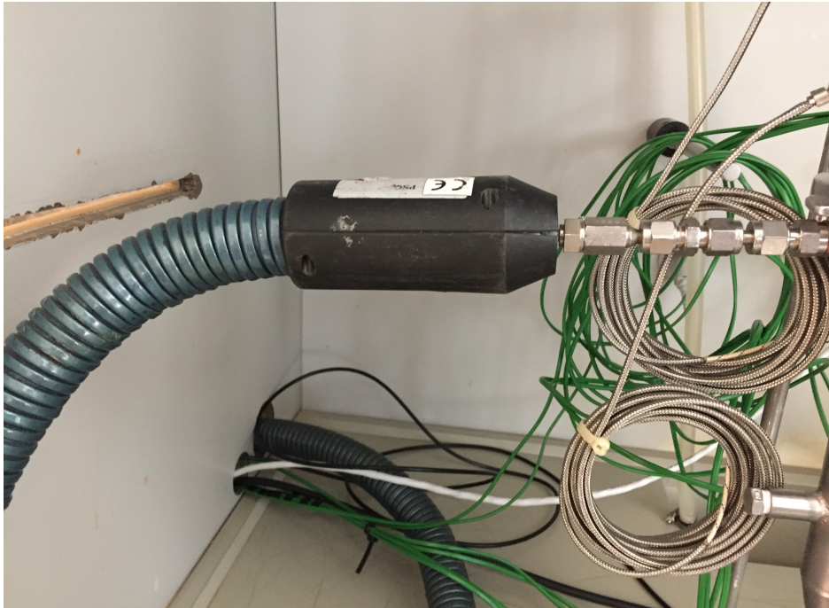
Figura 4.20. Sonda de muestreo instalada en el reactor.
