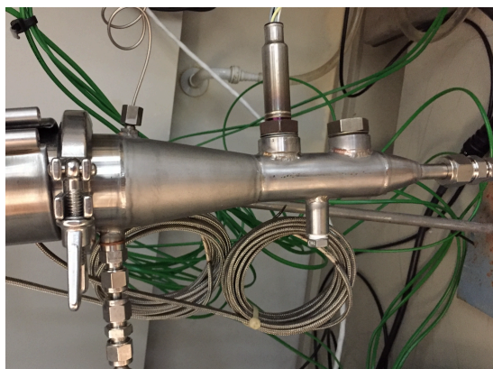
Figura 9.9. Conexión de sondas en el módulo de entrada.
