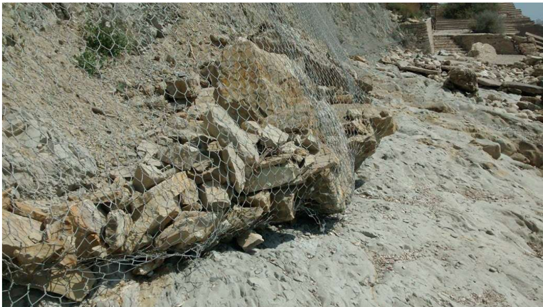
Imagen 5. Malla protectora en la ladera derecha
