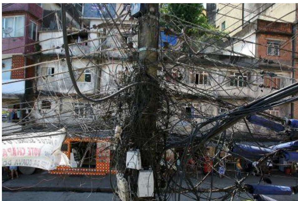
Imagen 3.8 - Conexiones eléctricas en un asentamiento informal. La clandestinidad aumenta las posibilidades de incendios eléctricos. Fuente: (24Horas, 2011).
