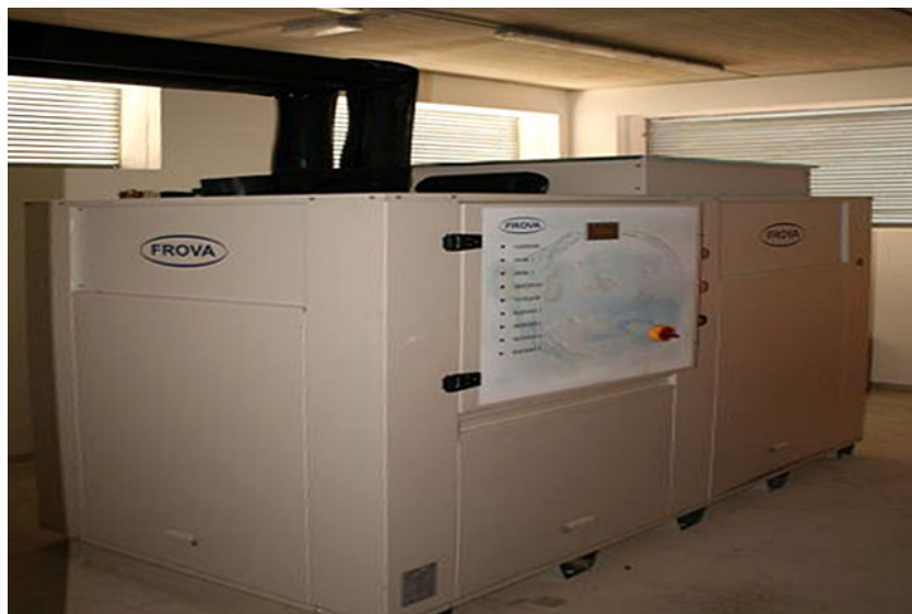
Figura6. Vista del sistema de agua glicolada.
