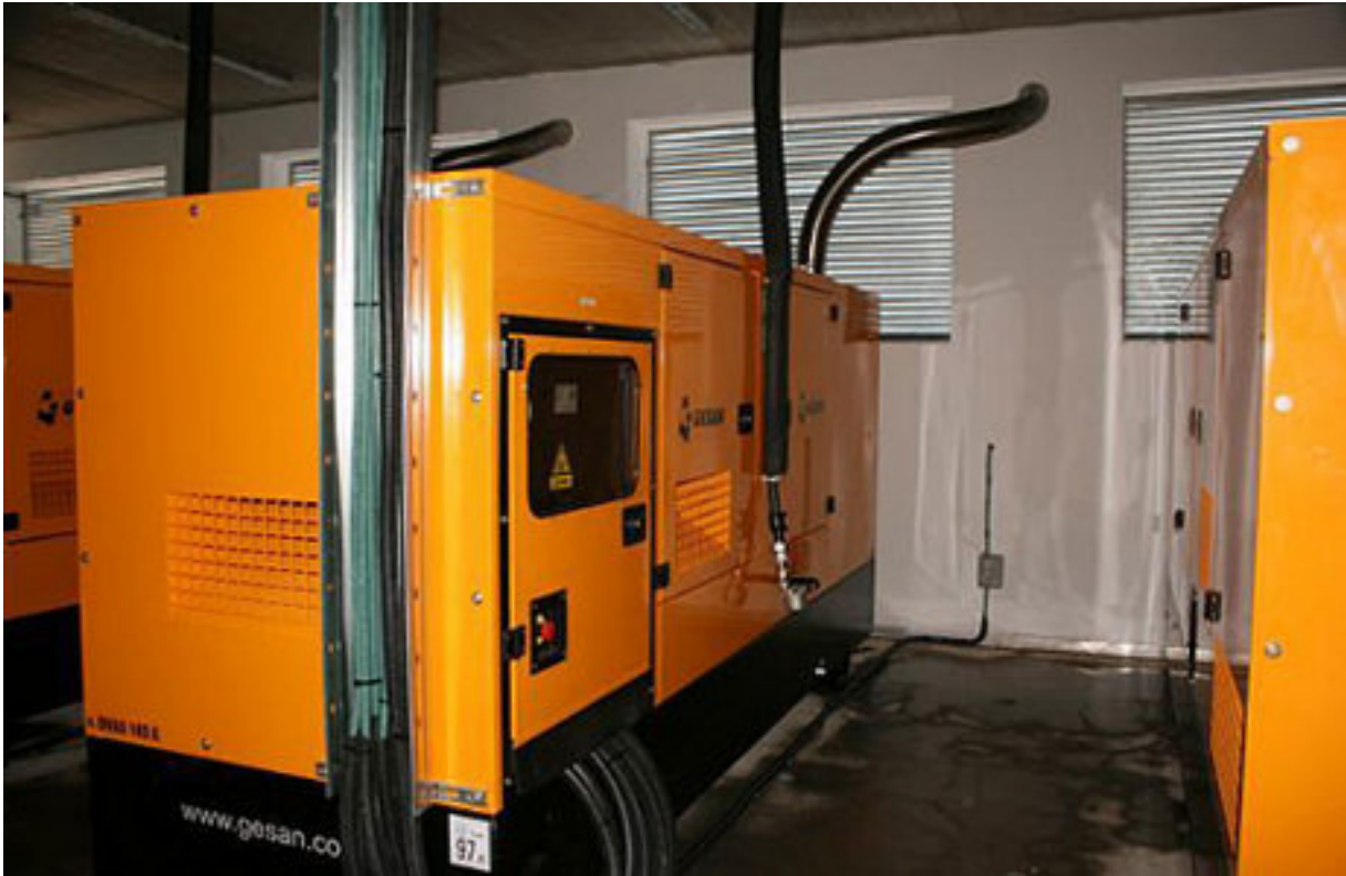
Figura5. Vista de la sala de generadores diésel.
