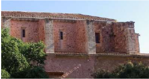
Figura 83. Imagen del ennegrecimiento en las fachadas de la Iglesia. Imagen propia 24/08/17
