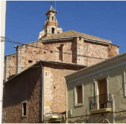
Figura 84. Imagen de la fachada que hace medianera con los demás edificios donde se muestra la pérdida de materiales. Imagen propia 24/08/17
