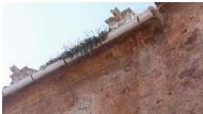
Figuras 87, 88, 89 y 90. Imagen del exterior de la iglesia donde se muestra la presencia de vegetación por toda la cubierta y fachada. Imagen propia 24/08/17
