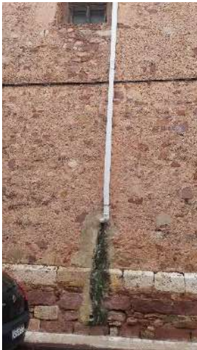
Figura 91. Imagen del canalón de la fachada de la calle Sant Joan. Imagen propia 24/08/17
