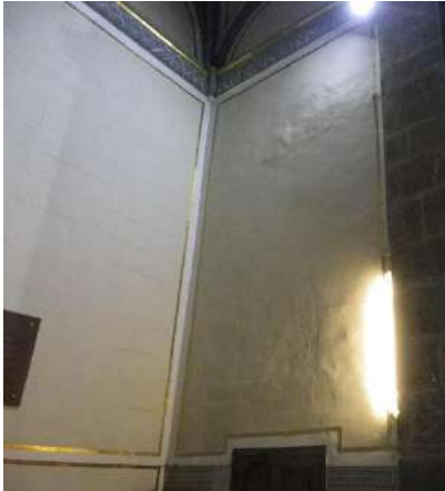
Figura 85. Imagen del interior de la iglesia donde se aprecia el deterioro en su revestimiento. Imagen propia 24/08/17
