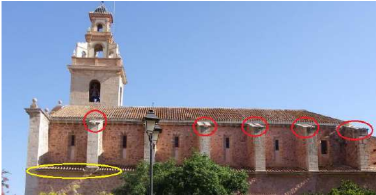
Figura 75. Imagen señalizando la evacuación en los contrafuertes y los canalones de las cubiertas de las capillas. Imagen propia 20/08/17
