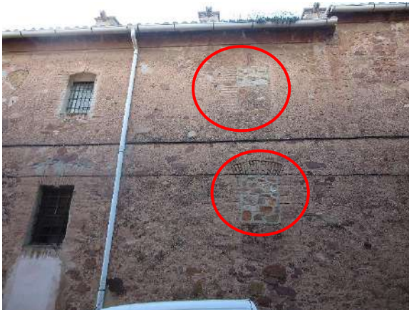
Figura 46. Imagen de antiguas ventana tapiadas. Imagen propia, 10/03/17
