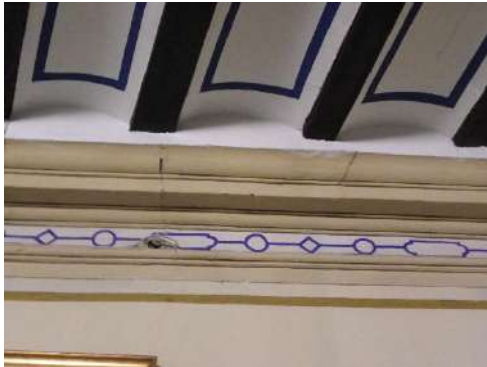
Figura 80. Imagen de la grieta presente en el forjado de la sala de despacho del cura. Imagen propia 24/08/17
