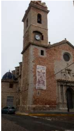
Figura 86. Imagen del exterior de la iglesia donde se muestra la humedad por capilaridad. Imagen propia 24/08/17
