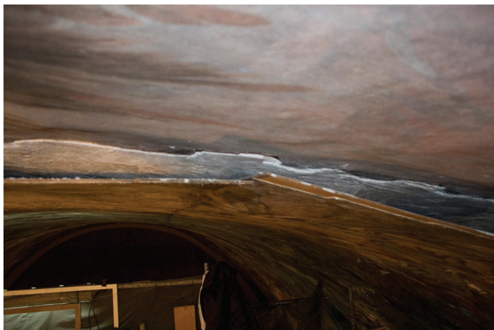
Figura 61. Detalle de la parte arrancada (pinturas de la bóveda). Iglesia de los Santos Juanes, Valencia.
