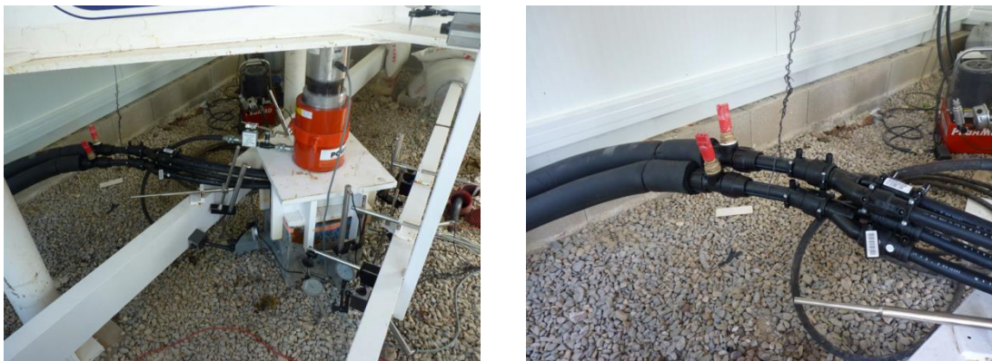
Figura IV-75: Conexionado con el pilote geotérmico. Conexión en Y y sondas de cabecera.
