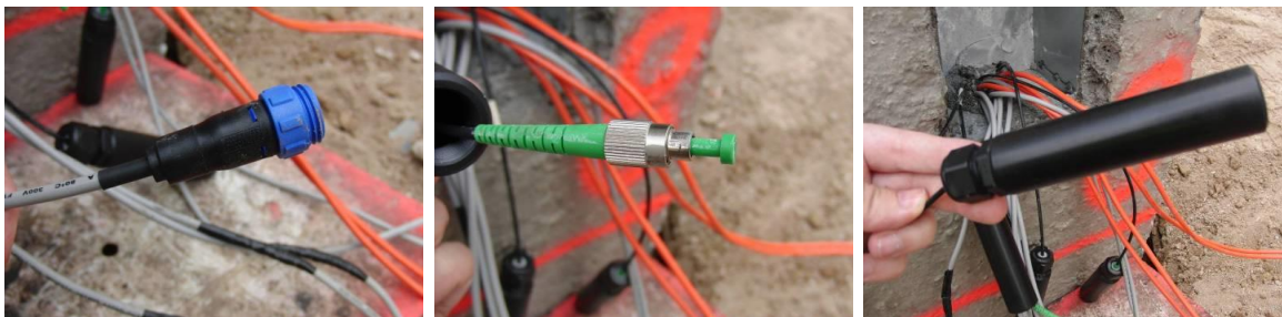
Figura IV-38: Conectores de extensómetros y fibra óptica. Manguito protector para conexión de fibra óptica
