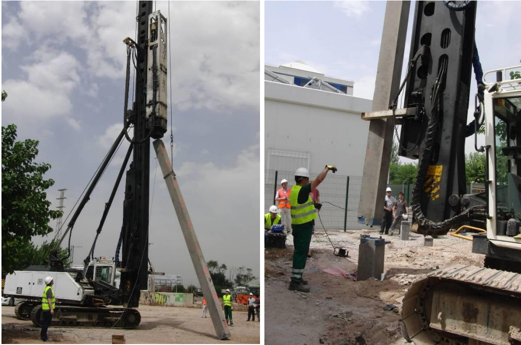
Figura IV-39: Izado del segundo tramo de pilote y colocación en posición para la realización de las conexiones
