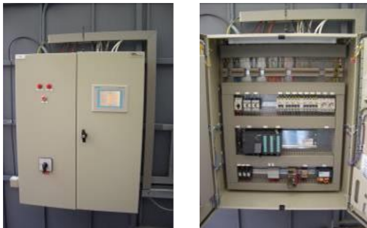
Figura IV-74: Armario con los elementos de control de la instalación
