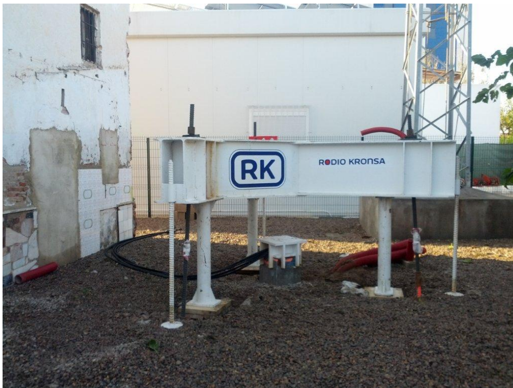
Figura IV-72: Estado final de la instalación
