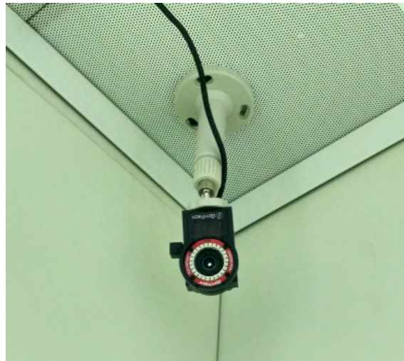
Figura 3.8: Detalle de una cámara de la instalación Optitrack
