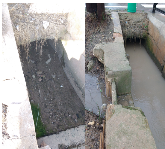
Ilustración 1. Punto de vertido N-267 en tiempo seco y en lluvia
