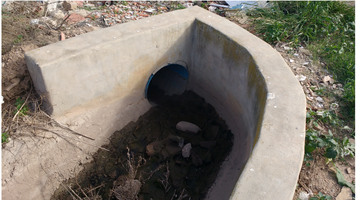
Ilustración 13. Vertido a acequia N-206
