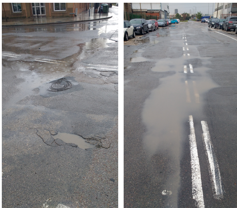
Ilustración 10. Estado del firme en la avenida Karl Marx
