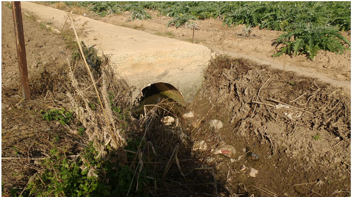
Ilustración 14. Vertido a acequia N-131
