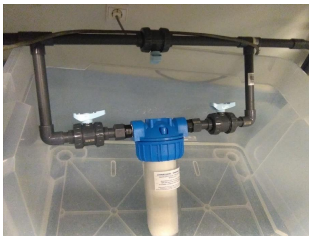
Figura 5.5: Filtro recogedor de partículas. Fuente [Autor].
